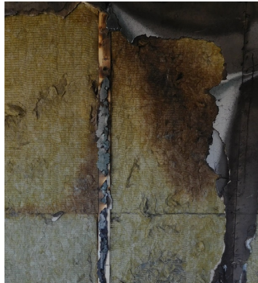
Abb. 12: Verfärbungen an den Befestigungspunkten am Ständer einer Holztafelbauwand, Versuch V4 aus TIMpuls
