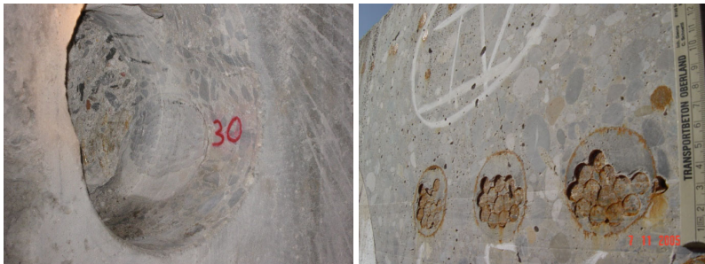
Abb. 3 Links: Abgebohrtes Längsspannglied; Foto: Adam Hörnig Baugesellschaft mbH, rechts: Planmäßiger Einzug von durchtrennten Spanngliedern
