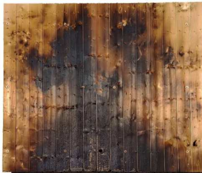
Bild 7: Fotodokumentation der Holzschalung oberhalb der Brandsperre nach Beendigung des Versuches und der Beobachtungszeit für Test 3 [6]
