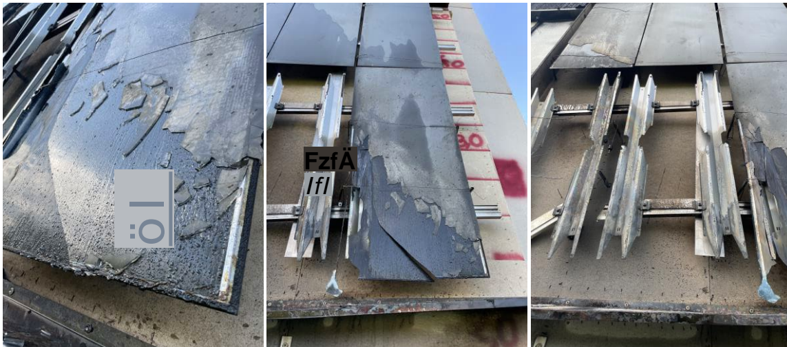
Abbildung 146: Schäden an der PV-Fassade nach dem Brandversuch
