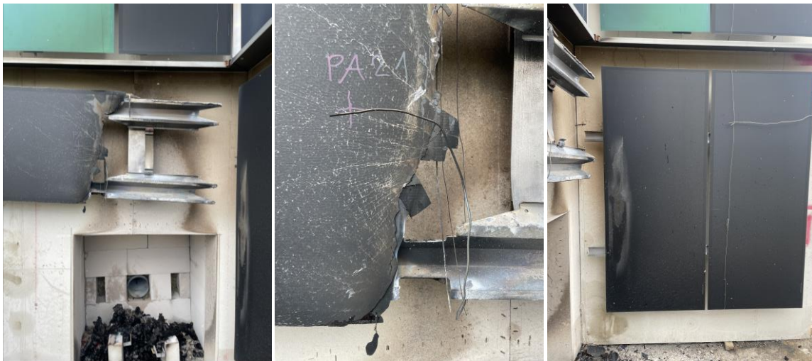
Abbildung 133: Schäden an der Fassade nach Brandversuch, Horizontales Modul (links und Mitte), Modul rechts der Brandkammer (rechts) ■
