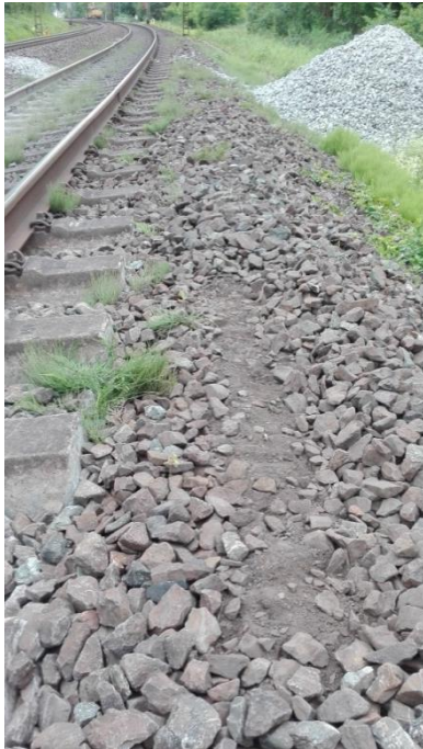
Abbildung 2-3: Verschmutzter Vorkopf-bereich der Schwellen [1.1 - 80]
