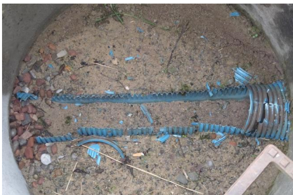
Abbildung 2-1: Defekte und verschmutzte Tiefenentwässerung [1.1 - 80]
