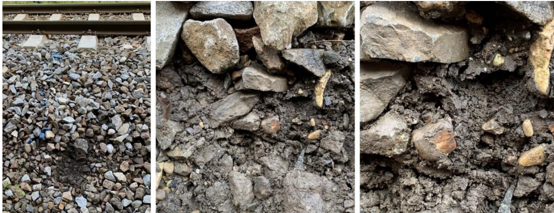
Abbildung 3-4 Mit Feinanteilen zugesetztes Schotterbett im August 2019, zwei Jahre nach Instandsetzung
