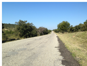
b) Unebene Fahrbahn, große Kurvenradien, aufgebrochener Asphalt
