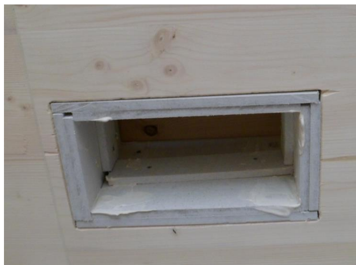
Abbildung 2-13 Mangelhafte Ausführung einer Laibungsbekleidung in den Ecken (eigene Darstellung)
