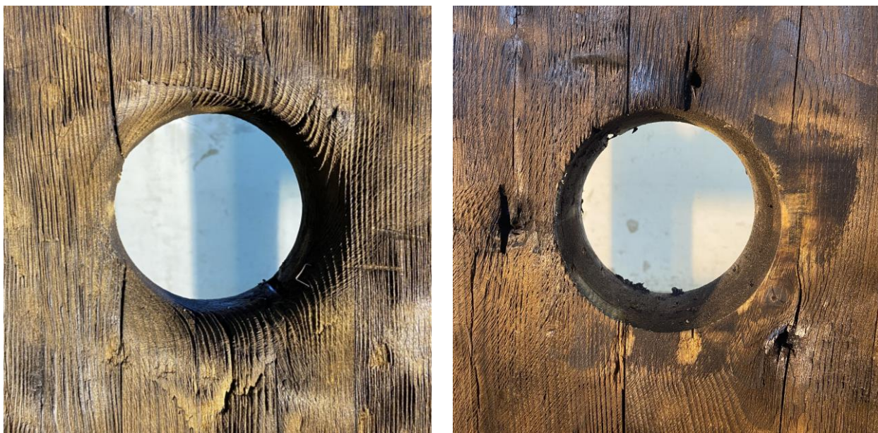
(a) Abbrandtrichter der Kabelhülse (BSH, PK 2b)
