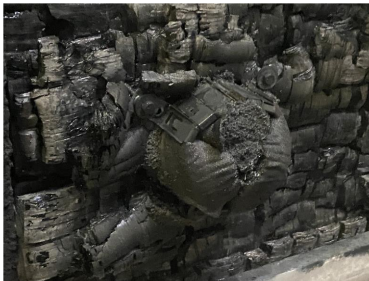
Abbildung 4-4 Verkohelter Rohrverschluss von Rohrmanschette nach Ablöschen der Tragkonstruktion
