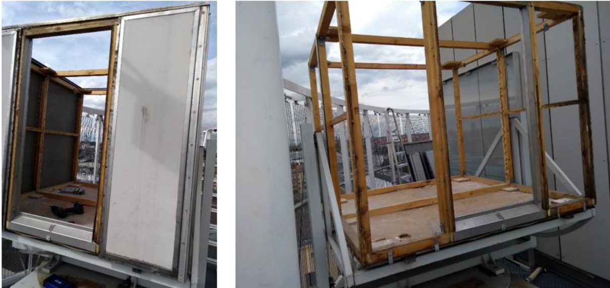
Abbildung 52 Zustand der Konstruktionen Ost und West
