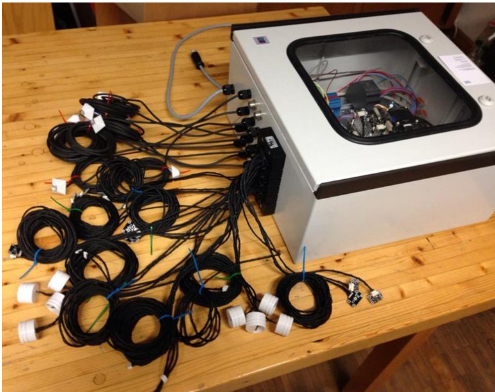
Abbildung 45 Messtechnik Schaltschrank mit Sensoren
