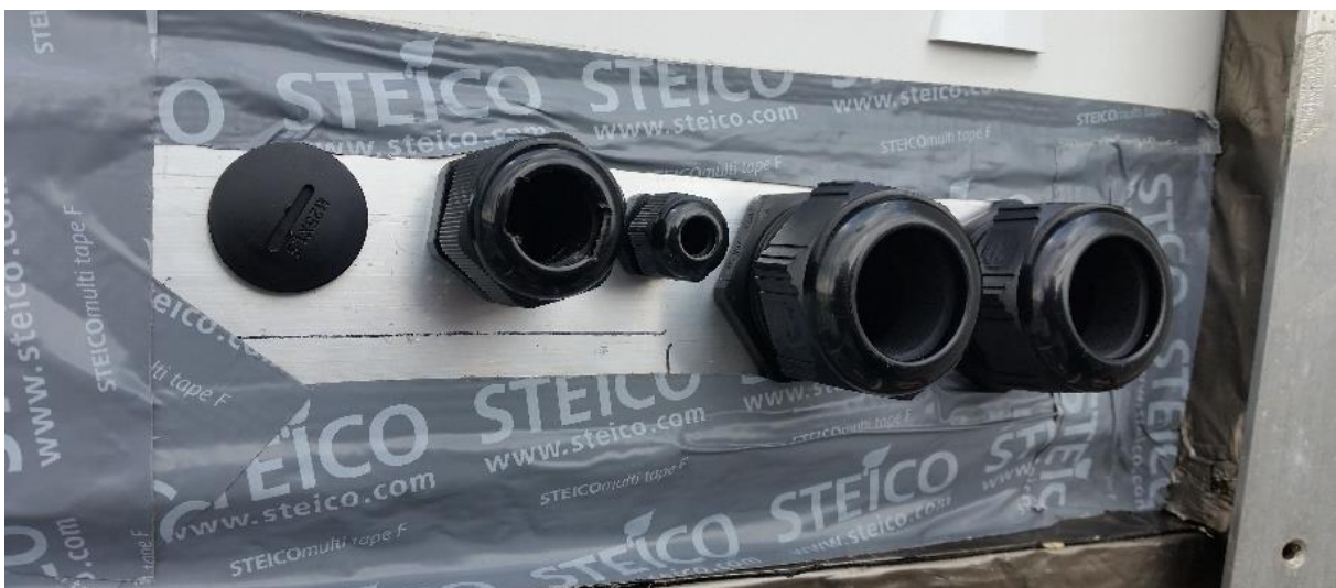
Abbildung 75 Durchführungsplatte im eingebauten Zustand
