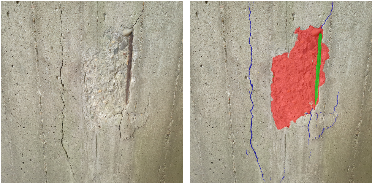
Abbildung 57: Segmentierung von Rissen (blaue Masken), Korrosion (grüne Maske) und Abplatzung (rote Maske) auf einem Testbild mit einem FPN-Modell.
