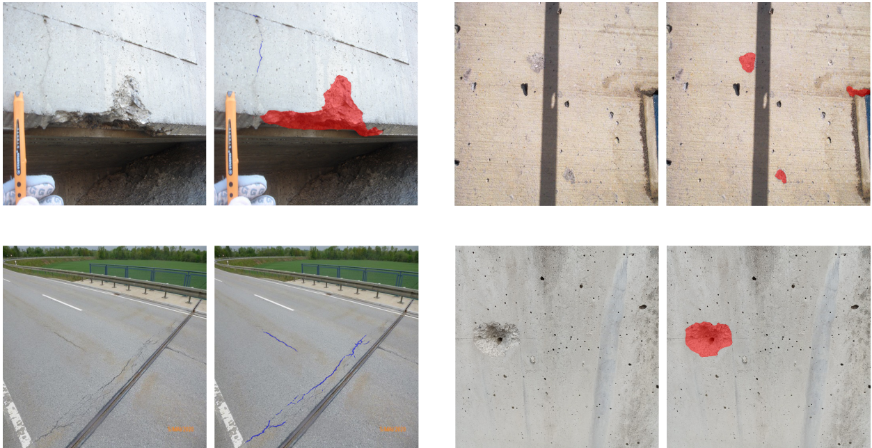
Abbildung 88: Segmentierungsergebnisse auf Beispielbildern von Schäden der Demonstratorbrücke St209/A99. Die Beispielbilder stammen aus der SIB-Bauwerke Datenbank.
