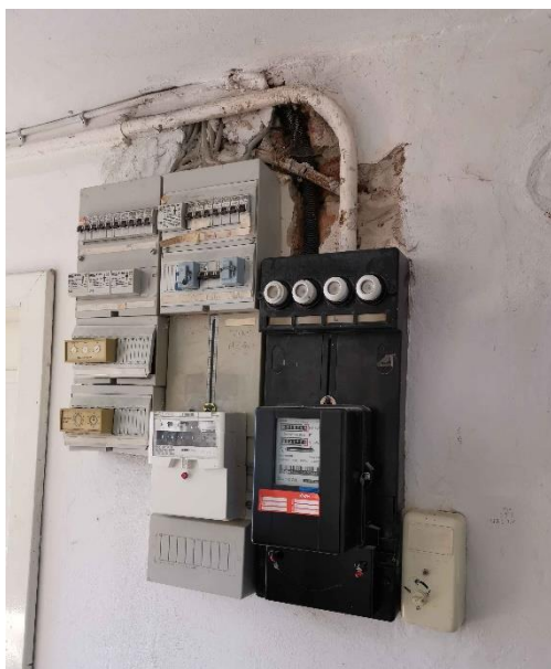
Abbildung 19: Veraltetes Stromsystem bzw. Sicherungskasten (eigene Aufnahme)
