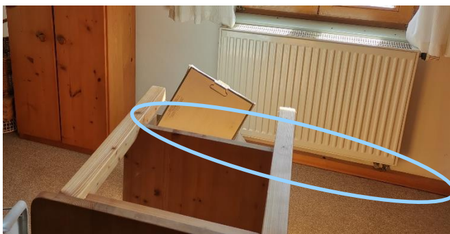
Abbildung 25: Raumseitig verlegte Verteilleitungen für Heizkörper (eigene Aufnahmen)
