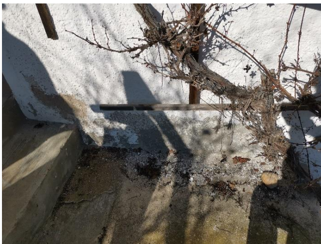
Abbildung 23: Putzabplatzungen an Außenwand (eigene Aufnahmen)
