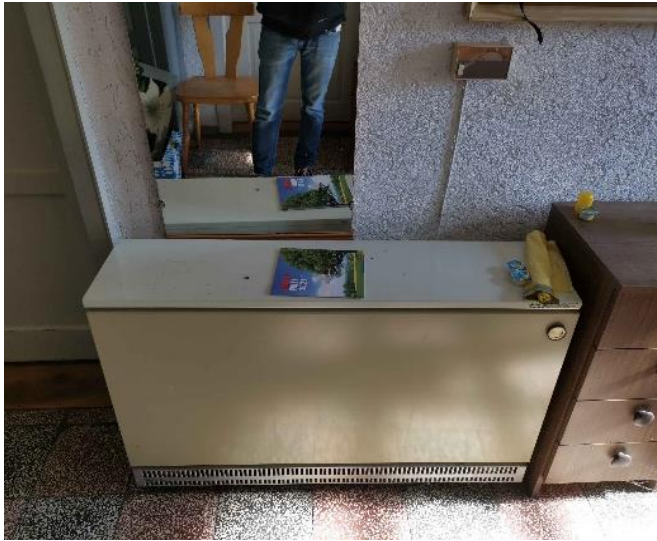
Abbildung 21: Heizungsanlage (Nachtspeicheröfen) im Sanierungsgebäude (eigene Aufnahmen)
