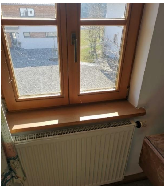
Abbildung 17: Sanierungsobjekt Fenster und Wärmeübergabe (eigene Aufnahmen)
