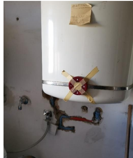
Abbildung 22: Veraltete und unfachmännisch verbaute Warmwasserbereitung (elektrischer Warmwasserboiler) (eigene Aufnahmen)
