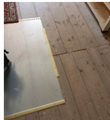
Abbildung 24: Fehlender Fußbodenbelag (eigene Aufnahmen)
