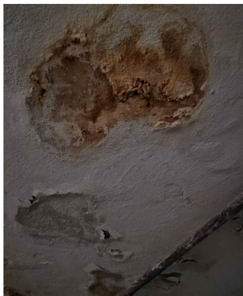
Abbildung 20: Farbabplatzungen und Schimmel an Außenwand (eigene Aufnahme)
