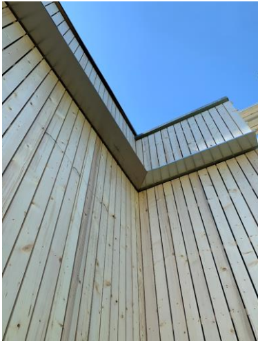
Abb. 10: Brandsperre aus Stahlblech
