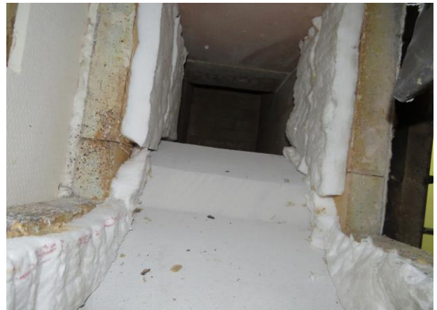
Auskleidung des Brandraumes (Keramikwolle)
