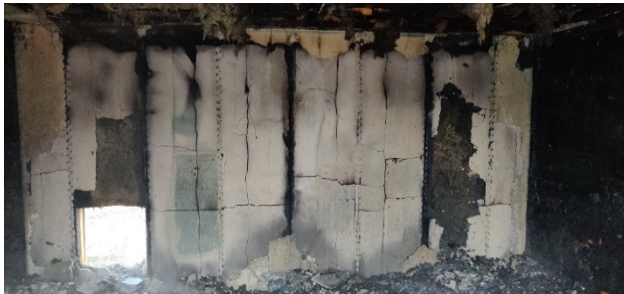
Abbildung 213: 133. Minute V2: Ende der Nachlöscharbeiten und Öffnung zur Entrauchung in Wand 2
