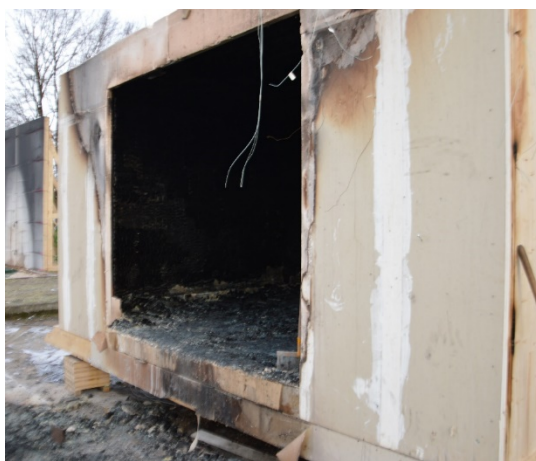
Abbildung 202: Nachkontrolle V1: Fugenbrand
