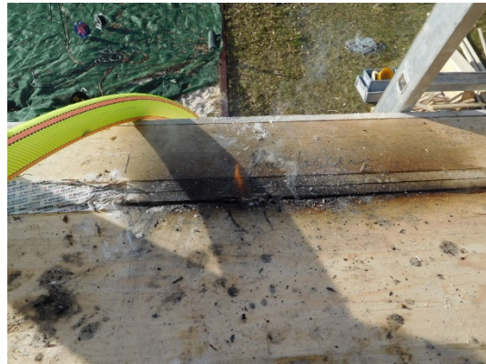
Abbildung 230: Nachkontrolle V3: Einbrand in Fuge Decke/Wand 3
