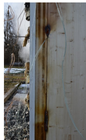
Abbildung 203: Nachkontrolle V1: Fugenbrand
