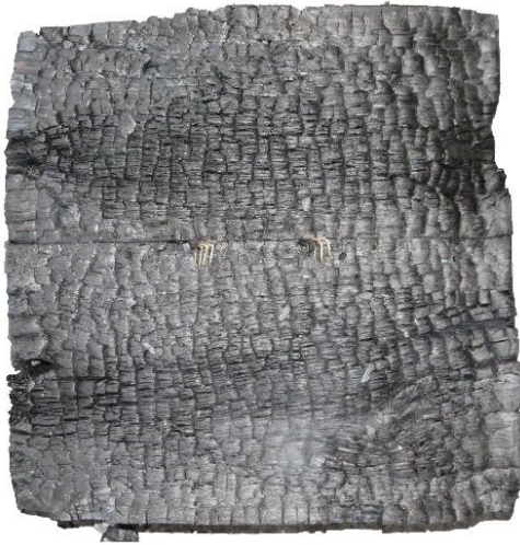
LH_VH_Ei_NBG_1D brandbeanspruchte Seite, Kohleschicht
