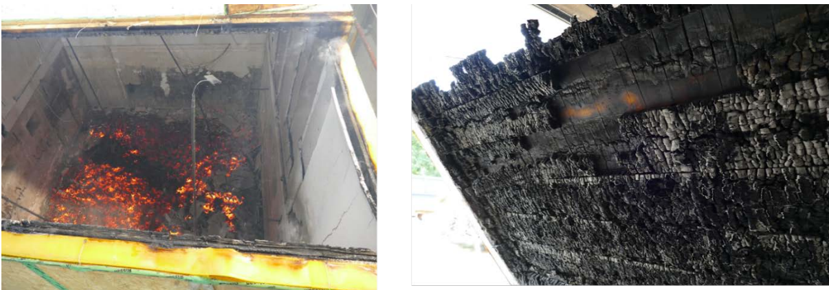
Abbildung 140: Aufnahme des Brandraumes kurz nach Abnehmen der Deckenelemente (links) beflamte Deckenseite (rechts) von V06
