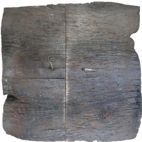
LH_VH_Ei_NBG_1D brandbeanspruchte Seite, Kohleschicht entfernt
