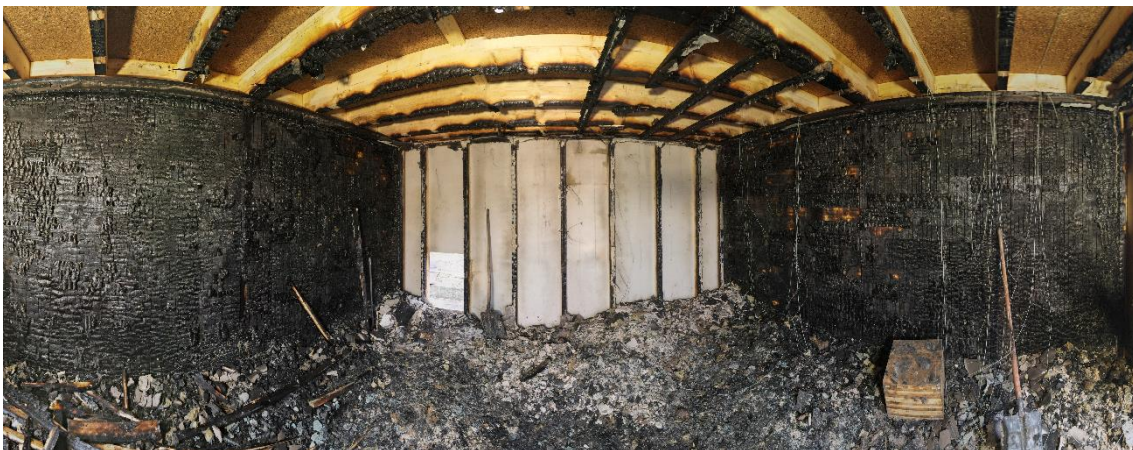
Bild 17 180° Dronenaufnahme der Bauteiloberflächen nach Demontage der Brandschutzbekleidung und Gefachdämmung für V2
