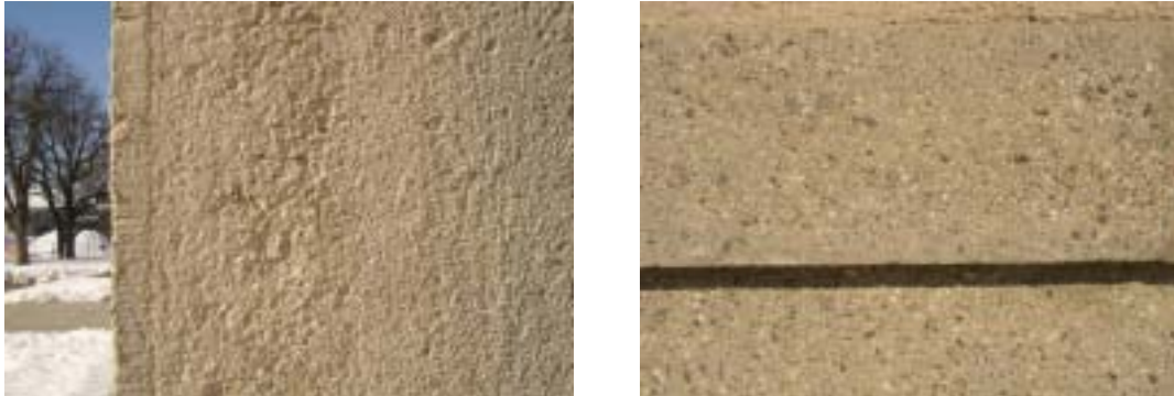
Abb. 14-15: Details der Betonoberfläche, Fassade der Messehalle III. Aufnahme im Februar 2004
