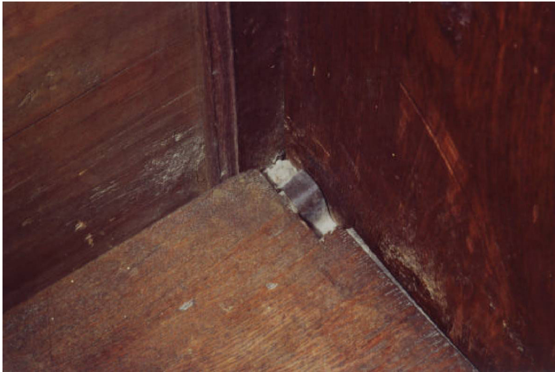
Abbildung 110: Stalle 10, rechter defekter Klappmechanismus
