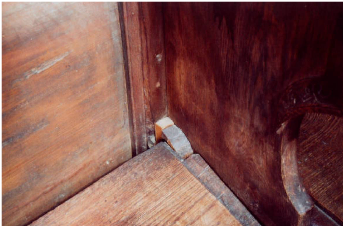
Abbildung 119: Stalle 17, reparierter rechter Klappmechanismus
