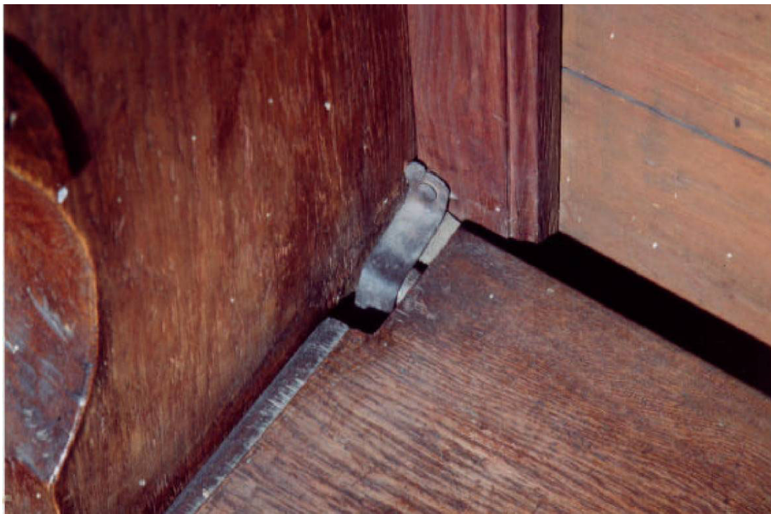
Abbildung 109: Stalle 10, linker defekter Klappmechanismus
