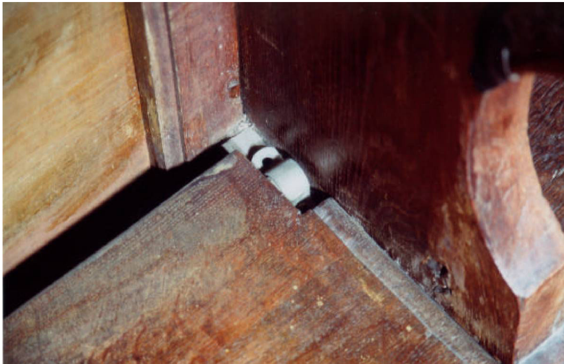
Abbildung 105: Stalle 7, defekter Klappmechanismus
