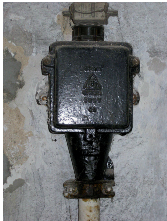
05. 011 / 1: Verteilerkasten der Firma Wiska, 1950–70. (Foto: Edlmann 2009)
