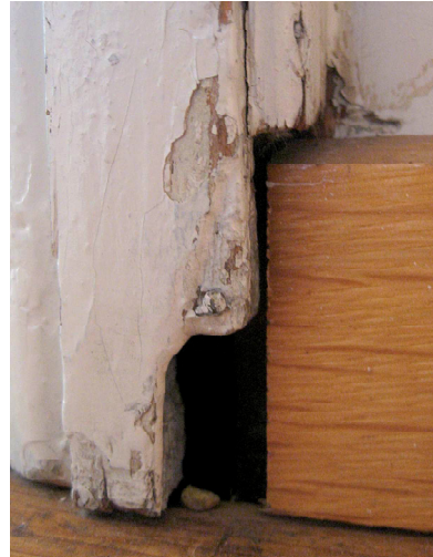
05.121/6 Aussparung im Türstock, evtl. zur Leitungsrohrdurchführung (Foto: Edlmann 2009).
