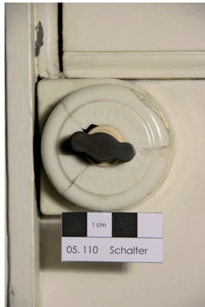
05.110/9 Türsockelapparat von Voigt & Haeffner neben Süd-Tür (Foto: Edlmann 2009).
