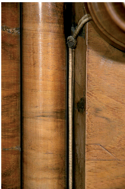
05.115/3 Klingelleitung neben Tür zu 05.117 (Foto: Edlmann 2009).
