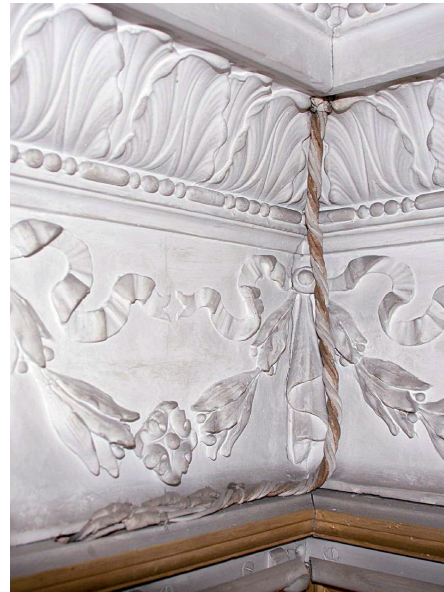
05.113/2 Nord-West-Ecke verseilte Litzenleitungen (Foto: Edlmann 2009).
