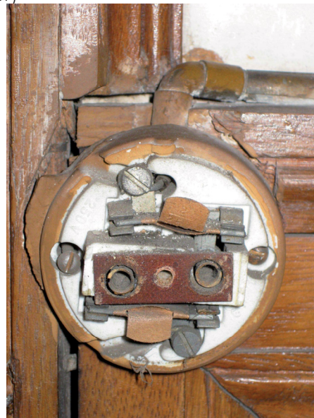
05.112/17 Steckdose Typ S512 der Siemens-Schuckertwerke, rechts neben der nördlichen Tür zu 05.111 (Foto: Edlmann 2009)
