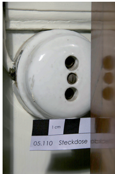
05.110/11 Steckdose Typ S 512 der Siemens-Schuckertwerke links neben südlichem Fenster (Foto: Edlmann 2009).
