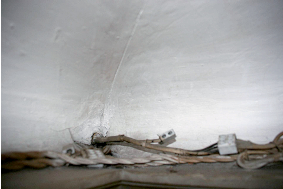
5.113/4 Nord-West-Ecke verseilte Litzenleitungen mit Lüsterklemmen (Foto: Edlmann 2009)
