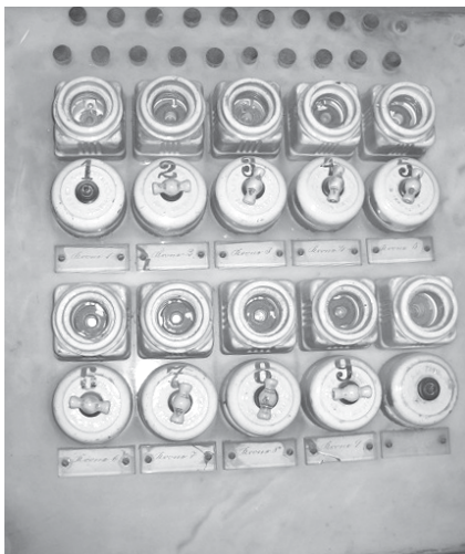
Abb. 50: Sicherungstafel, Neues Palais Potsdam, Depot. Foto: Edlmann 2009 mit Genehmigung der SPSPG.
