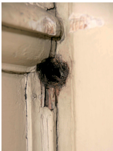
05.117/2 Loch im Türrahmen zu 05.121, das evtl. von einer Rohrdurchführung stammt (Foto: Edlmann 2009).
