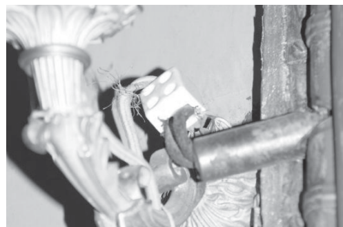
Abb. 89: Doppellüsterklemme zwischen Lampen- und Mantelrohrleitung, Schloss Erbach (Foto: Edlmann 2009)
