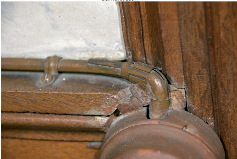
05.112/14 Steckdose Typ S512 der Siemens-Schuckertwerke, links neben südlicher Tür zu 05.111 (Foto: Edlmann 2009)
