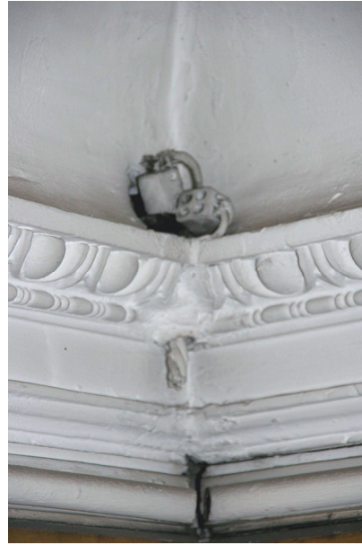
05.110/7 Leitungen mit Lüsterklemmen in Süd-West-Ecke (Foto: Edlmann 2009).
