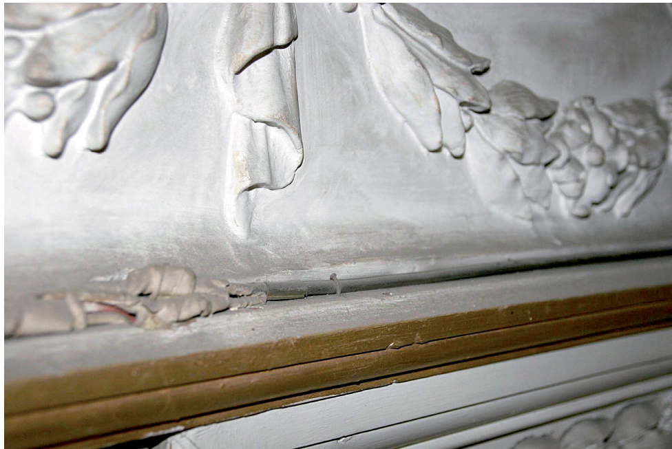
5.113/9 Rohrleitung und freiliegendes Leitungsende, hinter die Wandvertäfelung führend, über Tür zu 05.115 (Foto: Edlmann 2009).
