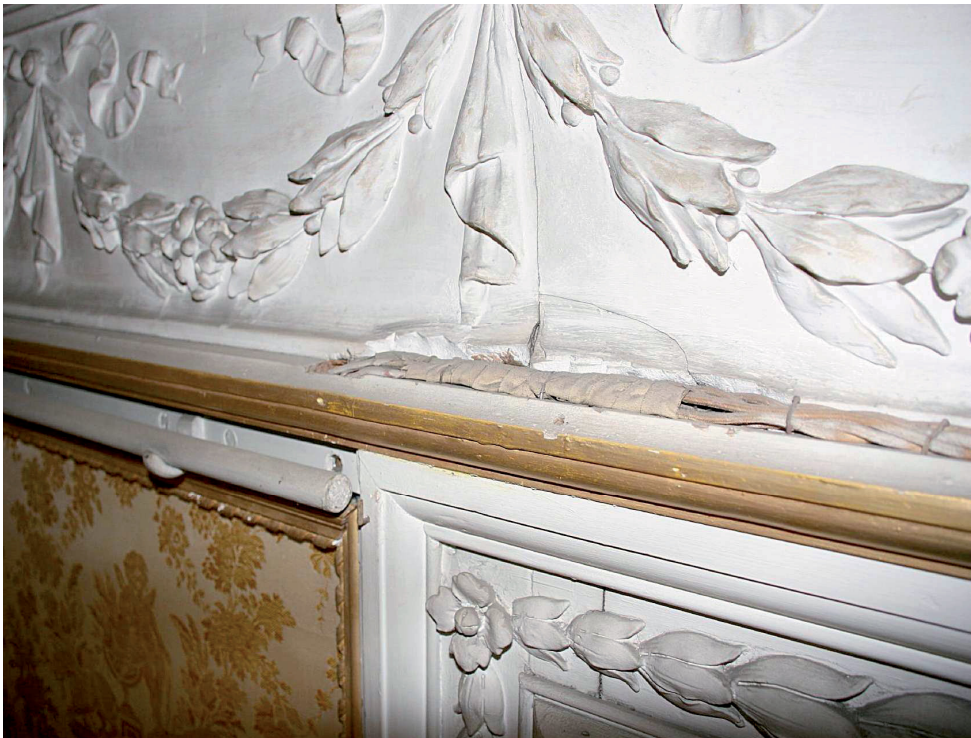
5.113/6 Verseilte Litzenleitungen über Tür zu 05.111 hinter Wandvertäfelung führend (Foto: Edlmann 2009).
