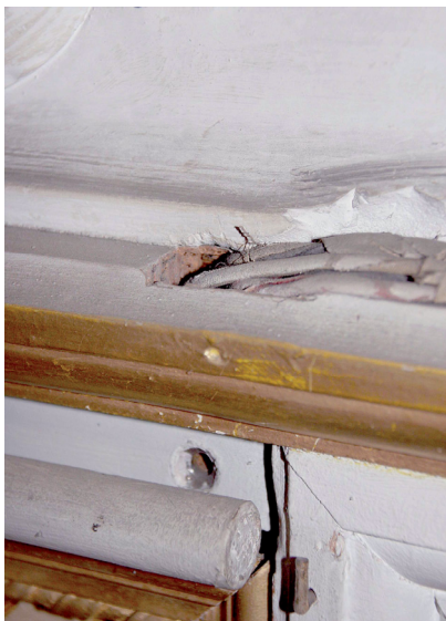
5.113/7 Leitung über Tür zu 05.111, Detail (Foto: Edlmann 2009).
