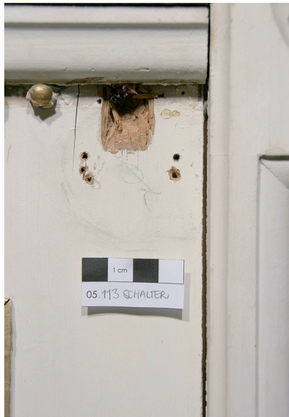
05.113/21 Spuren eines demontierten Installationselements links neben Tür zu 05. 111 (Foto: Edlmann 2009).
