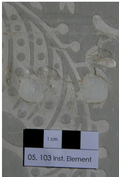
05.103/1: Verputzte Löcher rechts neben der Tür zu 05.102, evtl. Befestigungsspuren (Foto: Edlmann 2009).
