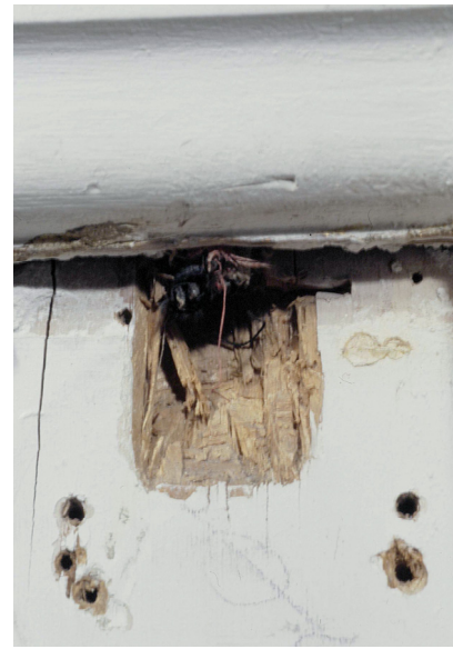
05.113/22 Spuren eines demontierten Installationselements links neben Tür zu 05. 111, Detail (Foto: Edlmann 2009).
