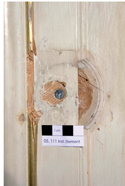
05.111/2 demontiertes Installationselement, evtl. Schalter von Voigt & Haeffner neben Tür zu 05.113 (Foto: Edlmann 2009).
