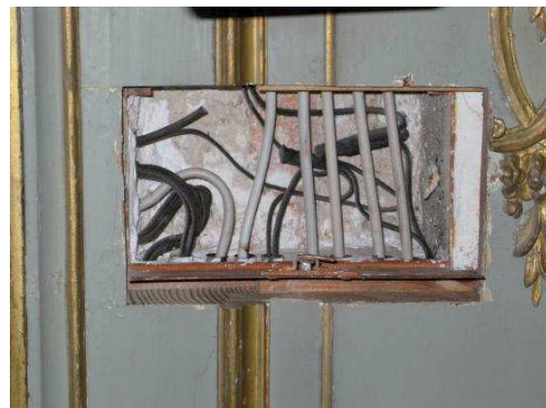
Abb. 79: Zugschacht mit neuen und alten Leitungen (Foto: Edlmann 2009, mit Genehmigung der SPGSG).
