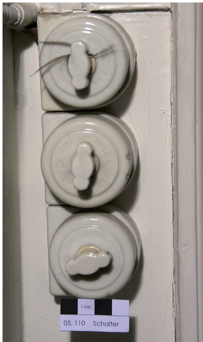
05.110/15 3 Türsockelapparate von Voigt & Haeffner neben Tür zu 05.111, Detail (Foto: Edlmann 2009).
