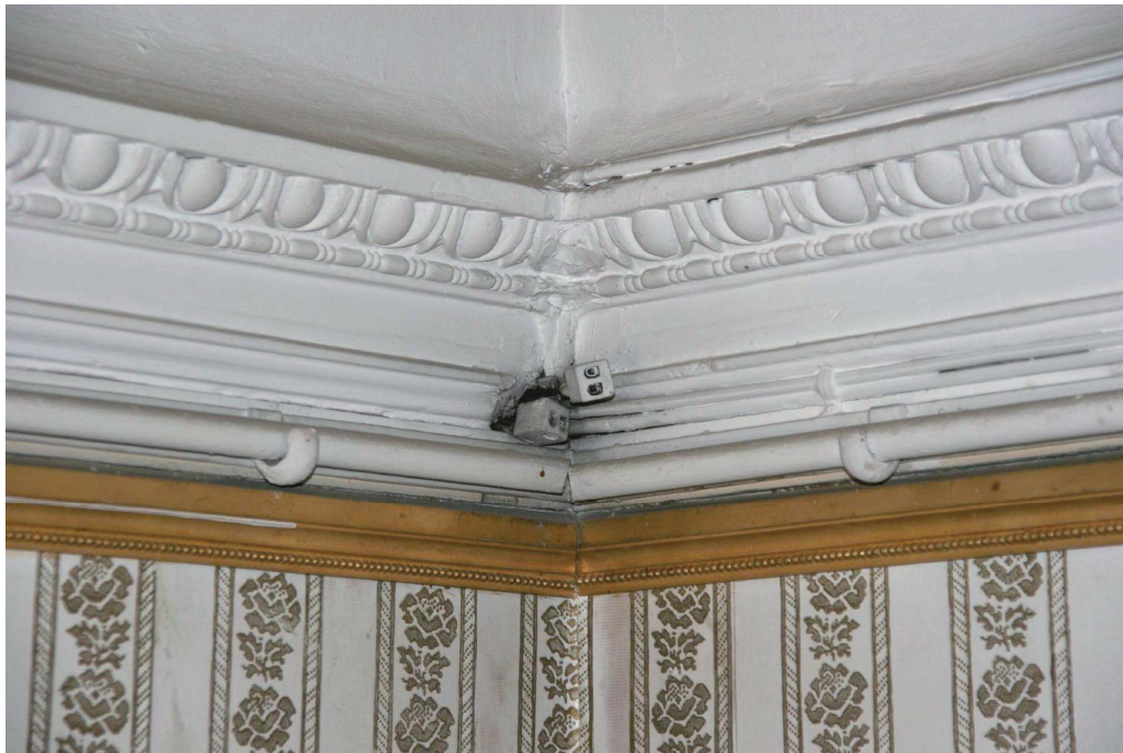
05.110/2 Leitungen mit Lüsterklemmen in Nord-Ost-Ecke (Foto: Edlmann 2009).
