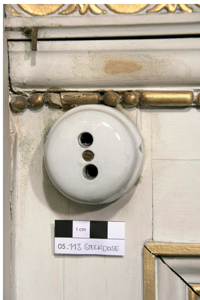
5.113/14 Steckdose Typ S512 der Siemens-Schuckertwerke rechts neben Tür zu 05.115 (Foto: Edlmann 2009).
