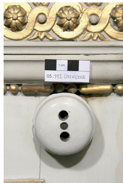
5.113/15 Steckdose Typ S512 der Siemens-Schuckertwerke links neben Kamin (Foto: Edlmann 2009).
