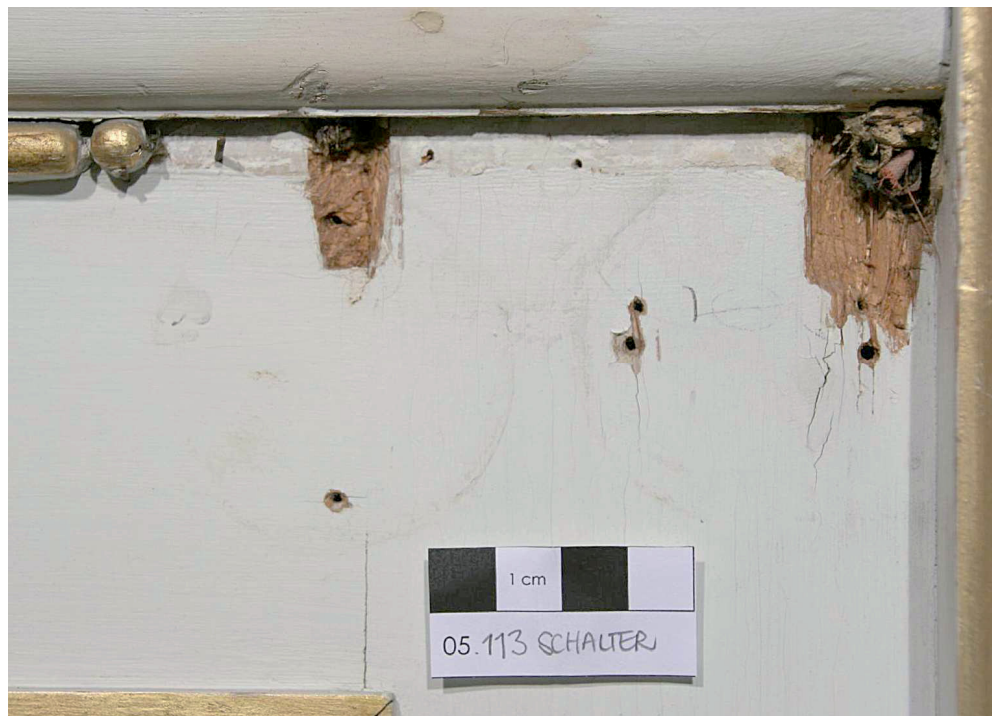
05.113/23 Spuren von demontierten Installationselementen links neben Tür zu 05. 115 (Foto: Edlmann 2009).
