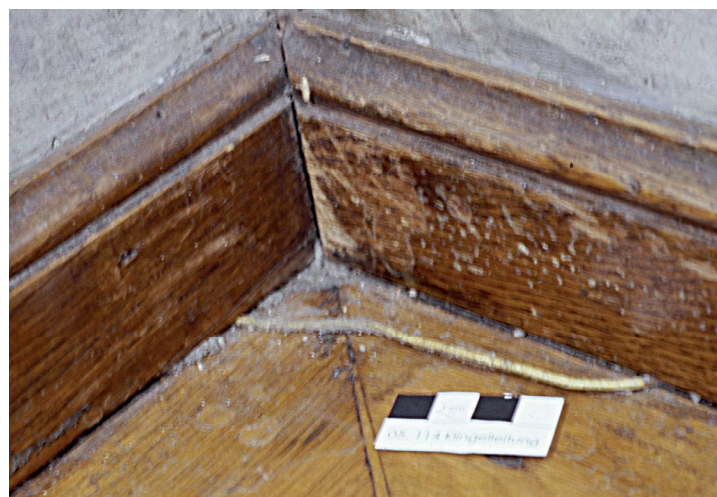
05.114/5 Leitung an Nordwand unterhalb des Gesimses mit Klemmhäuschen (Foto: Edlmann 2009).
