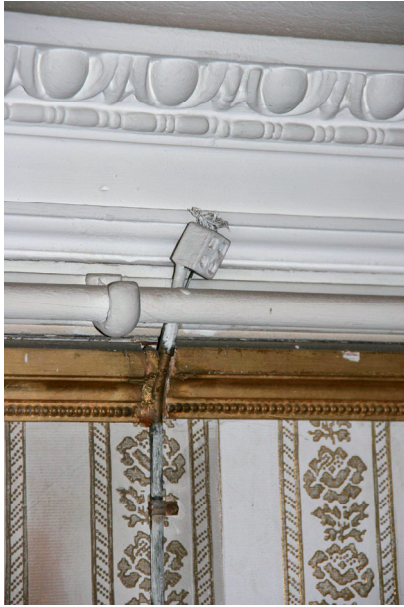
05.110/6 Leitungen mit Lüsterklemmen über südlichem Fenster (Foto: Edlmann 2009).
