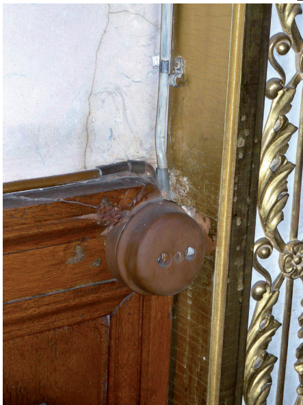
05.112/16 Steckdose Typ S512 der Siemens-Schuckertwerke, links neben dem Spiegel (Foto: Edlmann 2009)
