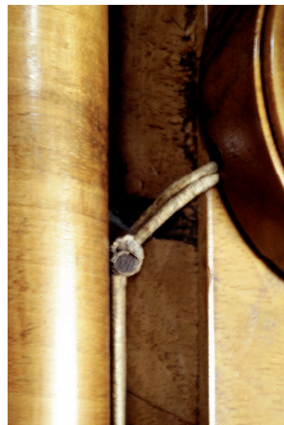
05.115/3 Klingelleitung neben Tür zu 05.117 (Foto: Edlmann 2009).
