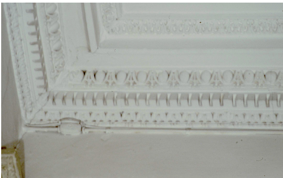
05.114/2 Klingelleitung in Süd-Ost-Ecke am Boden (Foto: Edlmann 2009).
