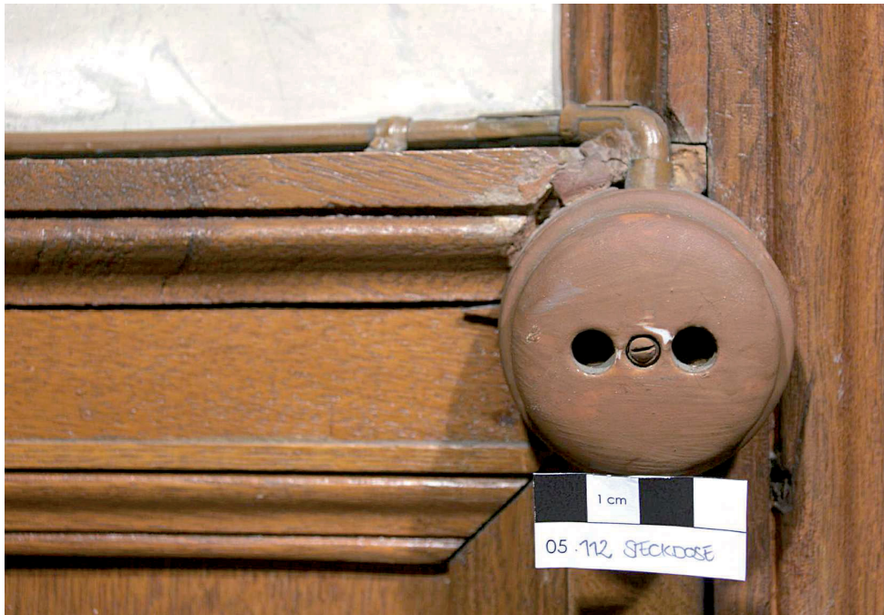
05.112/13 Steckdose Typ S512 der Siemens-Schuckertwerke, links neben südlicher Tür zu 05.111 (Foto: Edlmann 2009)
