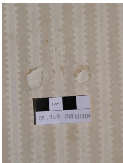
05.104/1: Verputzte Löcher rechts neben der Tür zu 05.101, evtl. Befestigungsspuren (Foto: Edlmann 2009).
