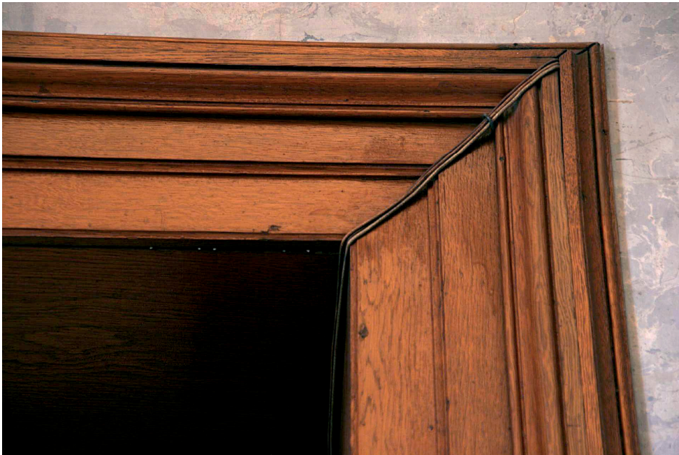
05.114/1 Klingelleitung am Türrahmen zu 05.112 (Foto: Edlmann 2009).
