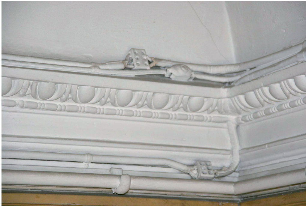
05.110/4 Leitungen mit Klemmhäuschen und Lüsterklemmen in Süd-Ost-Ecke zu 05.114 (Foto: Edlmann 2009).
