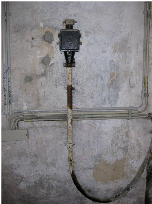
05. 011 / 2: Verteilerkasten der Firma Wiska, 1950–70, mit Leitung. (Foto: Edlmann 2009)
