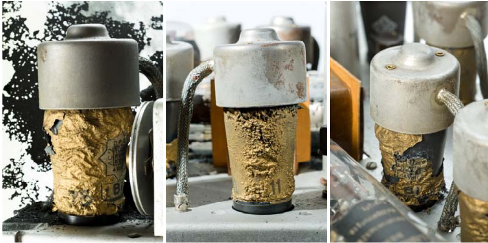
Abb. 28, 29, 30: Schäden an den Beschichtungen der Röhren 12, 3 und 8; [Fotos: H. CZECH, DM].
