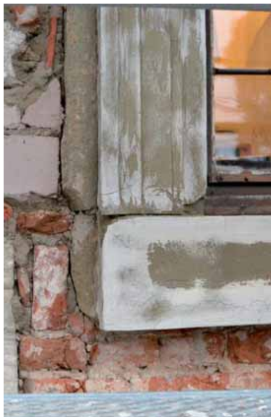
Abb. 48 Fenster F 1. 14, grob bearbeitete Unterputzkanten von Sohlbank und Leibung
