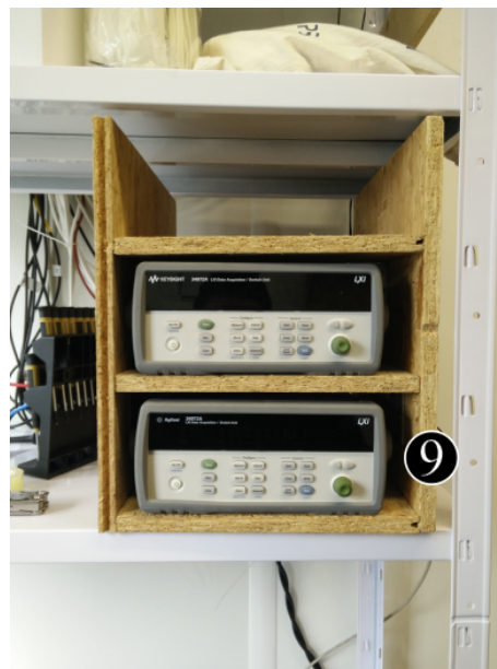
(d) Data acquisition / control unit
