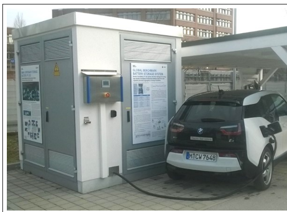
Abbildung 4.1: Für Messungen in Betrieb genommener Prototyp eines stationären 55 kW / 176 kWh Energiespeichersystems, aufgebaut aus gebrauchten Fahrzeugspeichern. Das Testsystem steht auf dem BMW Group Werksgelände in München und weist folgende Merkmale in der rechten Tabelle auf (auf Basis von [176]).
