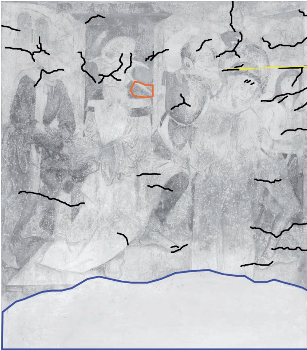
▲ Abb 303: BILDFELD 8, Kartierung, Schäden Malschicht, Maßstab 1:10
