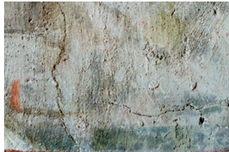
▲ Abb. 467: BILDFELD 19, Detail des unteren Bildbereiches mit Riss.
