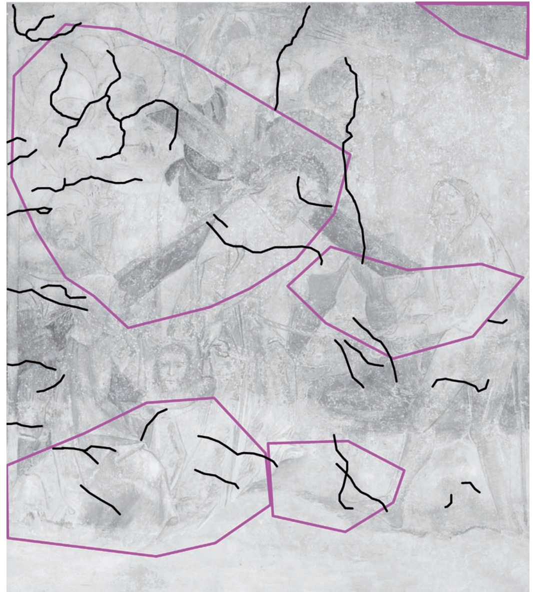
▲ Abb 327: BILDFELD 9, Kartierung, Schäden Putz, Maßstab ca. 1:10
