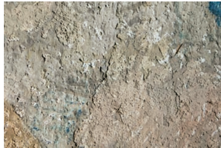
▲ Abb. 326: BILDFELD 9, Ausbruchstelle oben rechts
