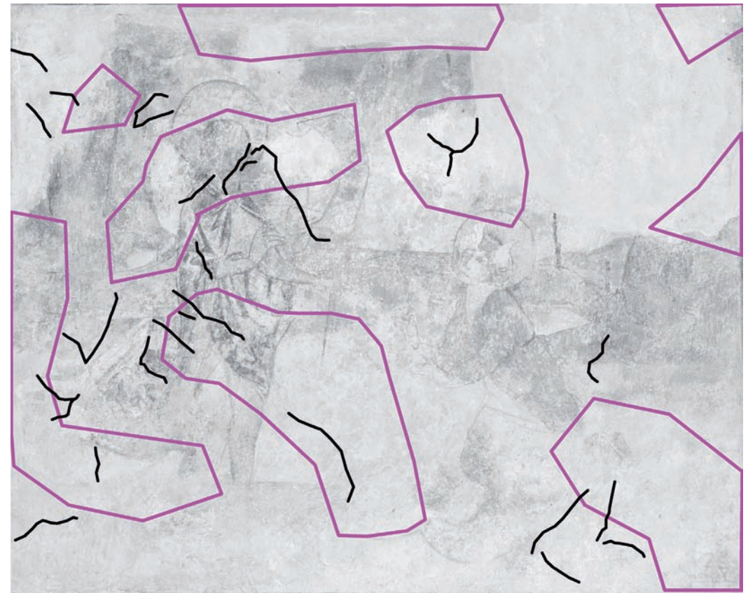
▲ Abb 422: BILDFELD 13, Kartierung Schäden Putz, Maßstab ca. 1:10
