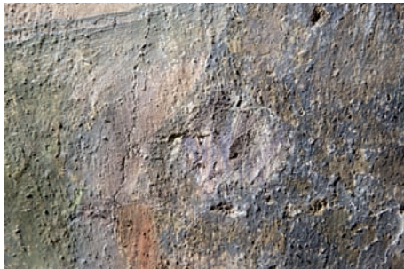
▲ Abb. 65: BILDFELD I, Ausbruchstelle oben rechts
