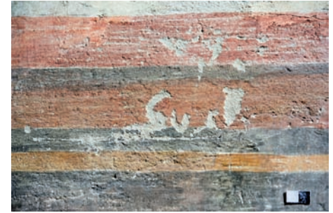
▲ Abb. 471: Gesims, Schaden durch mutwillige Kratzspuren
