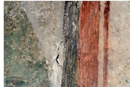
▲ Abb. 233: BILDFELD 6, Riss am rechten Bildrand
