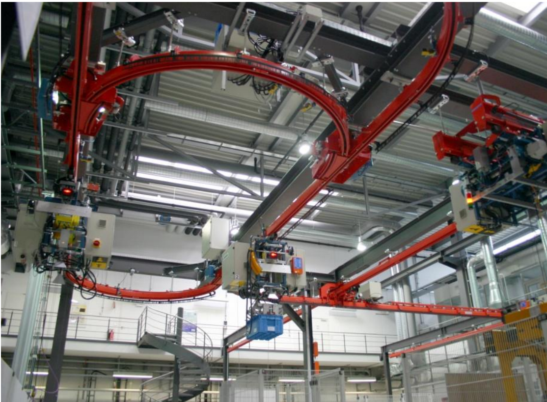
Abbildung 4-8: Elektrohängebahnanlage und Kranfeld in der Versuchshalle am Lehrstuhl fml
