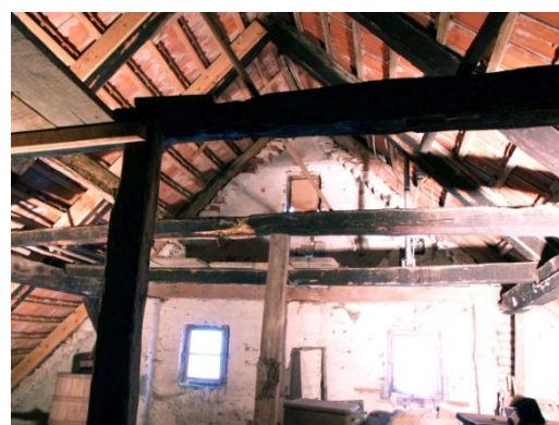
Abb. 18 Dachgeschoss, Blick nach Süden auf den gemauerten Südgiebel, Sparrendach mit Kehlbalkenlage und eingestelltem stehendem Stuhl, westliche Stuhlsäule der Binderachse 1 fehlt, Kehlbalken wurden in jüngerer Zeit von Rundhölzern unterstützt. Der Großteil der Hölzer ist stark mit Ruß geschwärzt.
