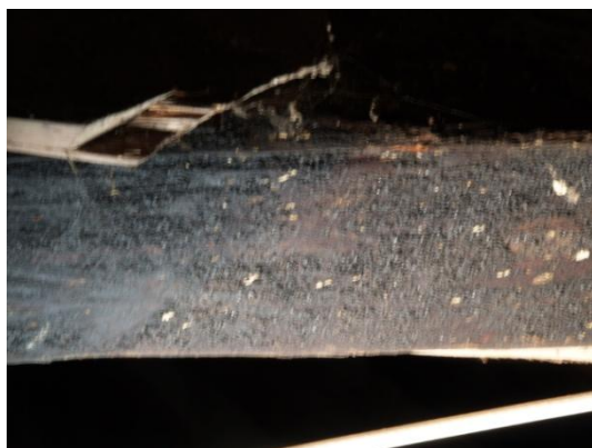
Abb. 54 Dachgeschoss, Kehlbalken, 3. Gespärre von Süd, Rußkruste auf der Unterseite des Holzes
