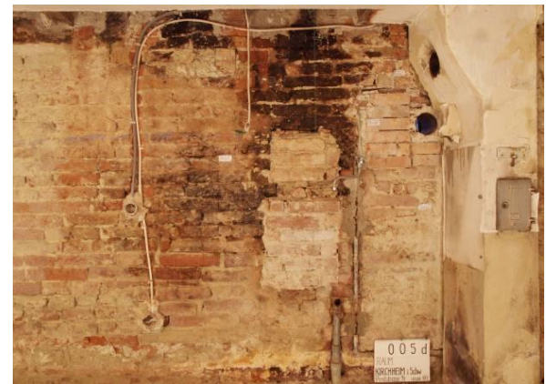
Abb. 32 Westwand, nach Abnahme der Spanholzplatten, ehemalige Herdstelle mit Schürloch für den Stubenofen
