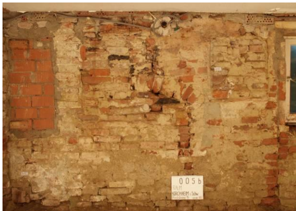
Abb. 31 Ostwand, nach Abnahme der Spanholzplatten, mittig ist die ehemalige Öffnung des Backofens zu erkennen. Daneben befinden sich zugesetzte Fensteröffnungen
