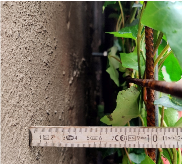
Abbildung 5.65 Abstand zwischen dem Rankgitter und der Wand des Prüfstandes
