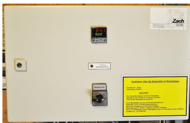
Abbildung 2.5: Steuerkasten für den Restwasserstrom
