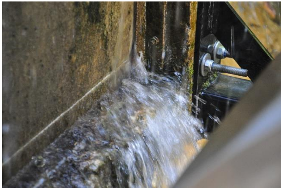
Abbildung 4.13: Wasserverluste vor dem Wasserrad
