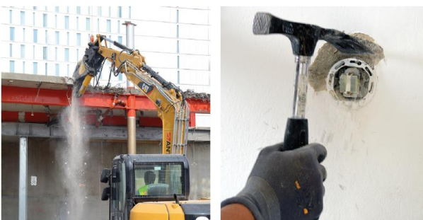
Abb. 7 Selektiver Abbruch mittels Abbruchzange (links), selektiver Rückbau von Installationen aus Mauerwerk (rechts) [3, S. 51]
