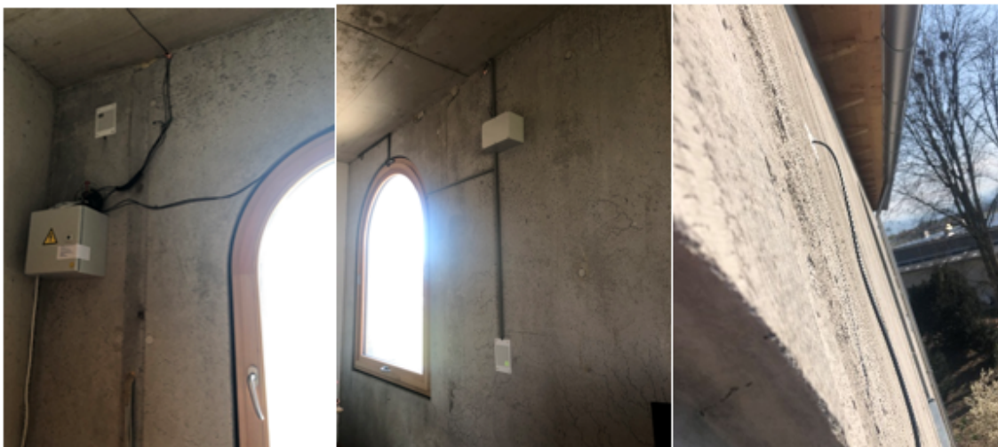
Abbildung 9: links: Messtechnik Westwand, mittig: Messtechnik Nordwand, rechts: Temperaturfühler Oberfläche außen Westwand Leichtbetongebäude
