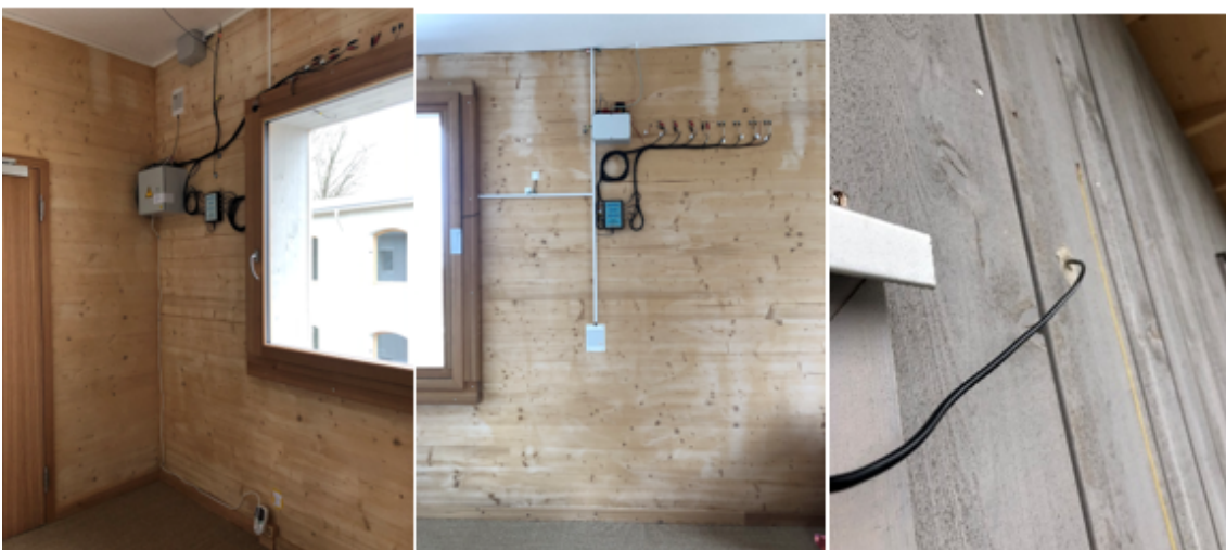
Abbildung 14: links: Messtechnik Westwand, mittig: Messtechnik Nordwand, rechts: Temperaturfühler Oberfläche außen Westwand Massivholzgebäude
