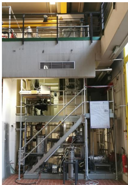
Abbildung 64: Foto der Kondensationsanlage an der Universität Paderborn.
