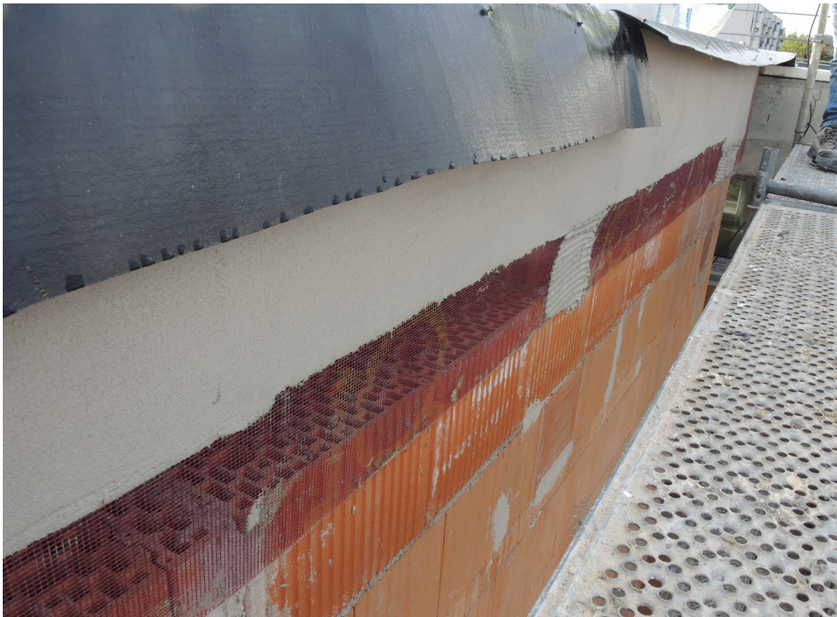
Abb. 1.1.-2 Aussparungen in der Fassade für Fassadenquartiere der Sperlinge (Bild: Sylvia Weber, LBV)
