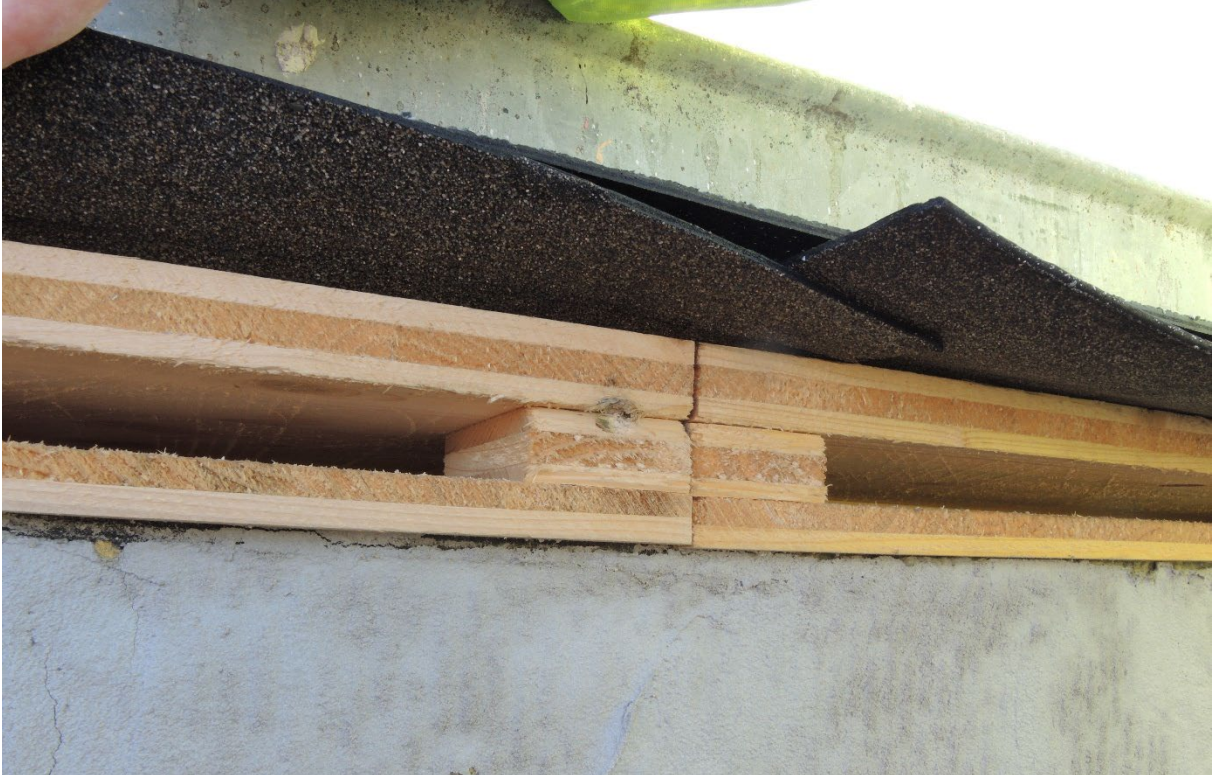
Abb. 1.2-24: Kontrolle des Einbaus der Fledermausspalten, hier richtiger Einbau der Bohlen (Bild: Sylvia Weber, LBV)
