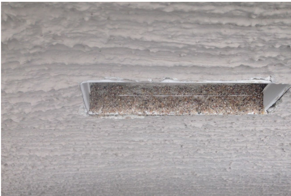
Abb. 1.2-4: Besandung der Einschlupflöcher zur Aufrauung der Oberfläche (Bild: Volker Eidner, IB Schmidt GmbH)
