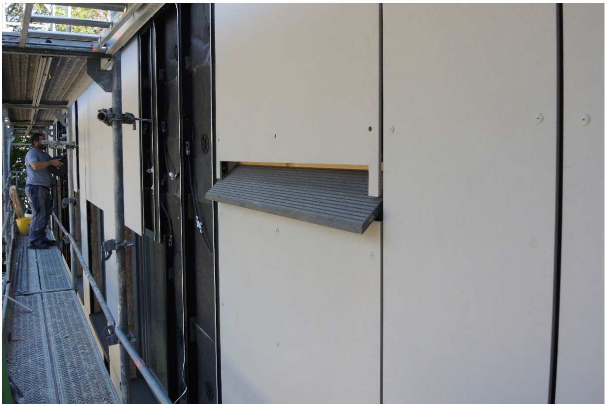
Abb. 1.2-17 Fertig eingebaute Einkammerkästen für Fledermäuse (Bild: Sylvia Weber, LBV)
