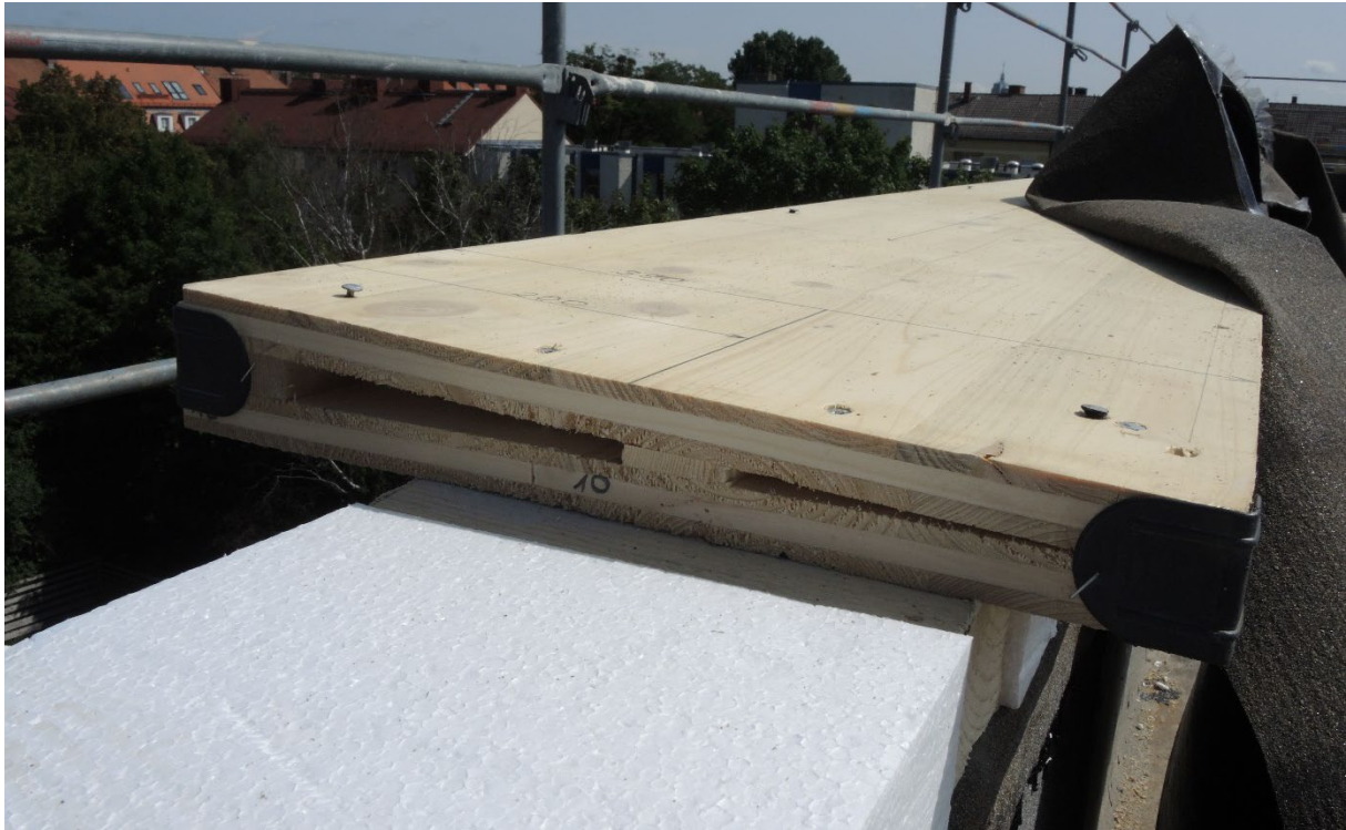
Abb. 1.2-22: Kontrolle des Einbaus der Fledermausspalten, hier falscher (horizontaler) Einbau der Bohlen (Bild: Sylvia Weber, LBV)
