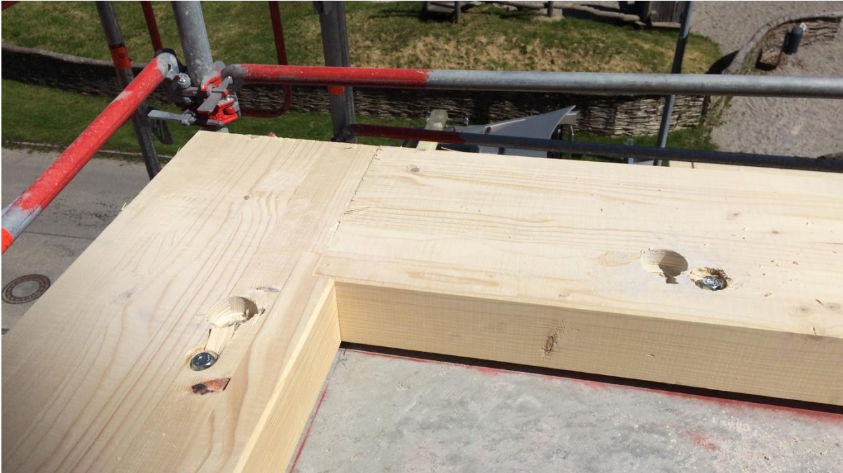
Abbildung 34: Die Holzprofile, auf denen die Außenwände lagern, werden in Lage und Höhe ausgerichtet und in der Betondecke verschraubt.
