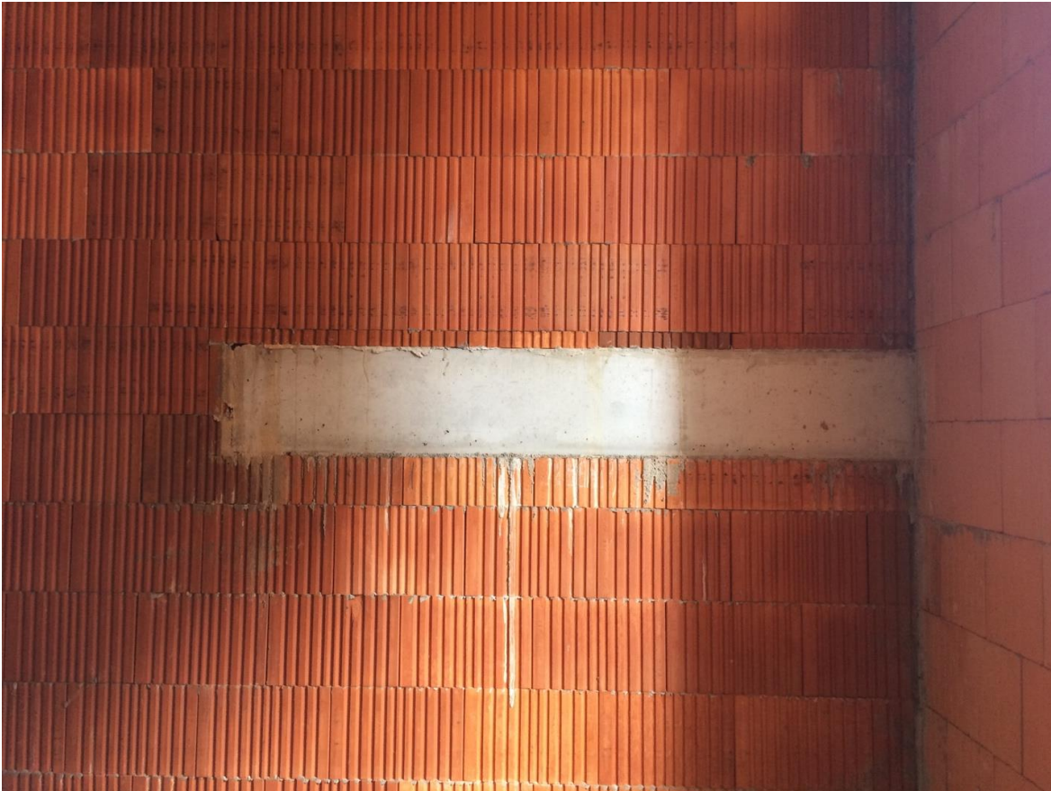
Abbildung 60: Auflager des Treppenpodests auf der tragenden Innenwand
