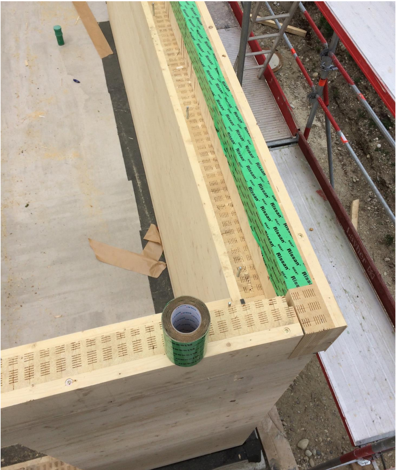
Abbildung 24: Hier ist die Aufkantung an der Außenecke zu sehen, die gleichzeitig die Randschalung für die Stahlbetondecke bilden wird.
