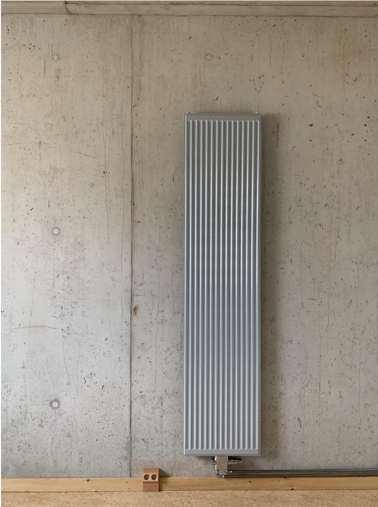
Abbildung 18: Die Heizkörper sind dicht am Vertikalstrang der Technik platziert und hochformatig, um viel Wandfläche für Möbel zu belassen.
