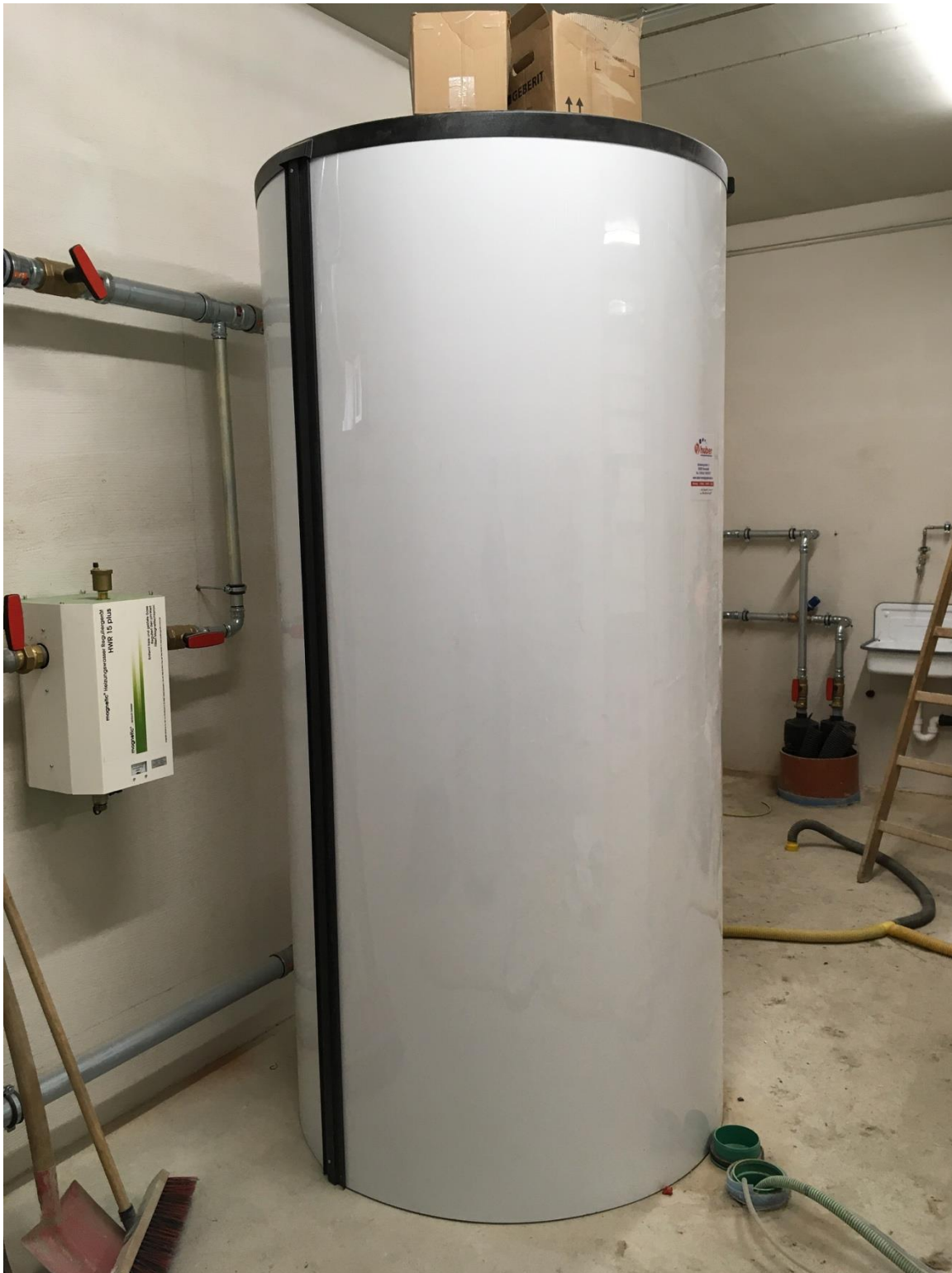
Abbildung 64: Im Mauerwerkshaus befindet sich auch der einzige Technikraum des Projekts.
