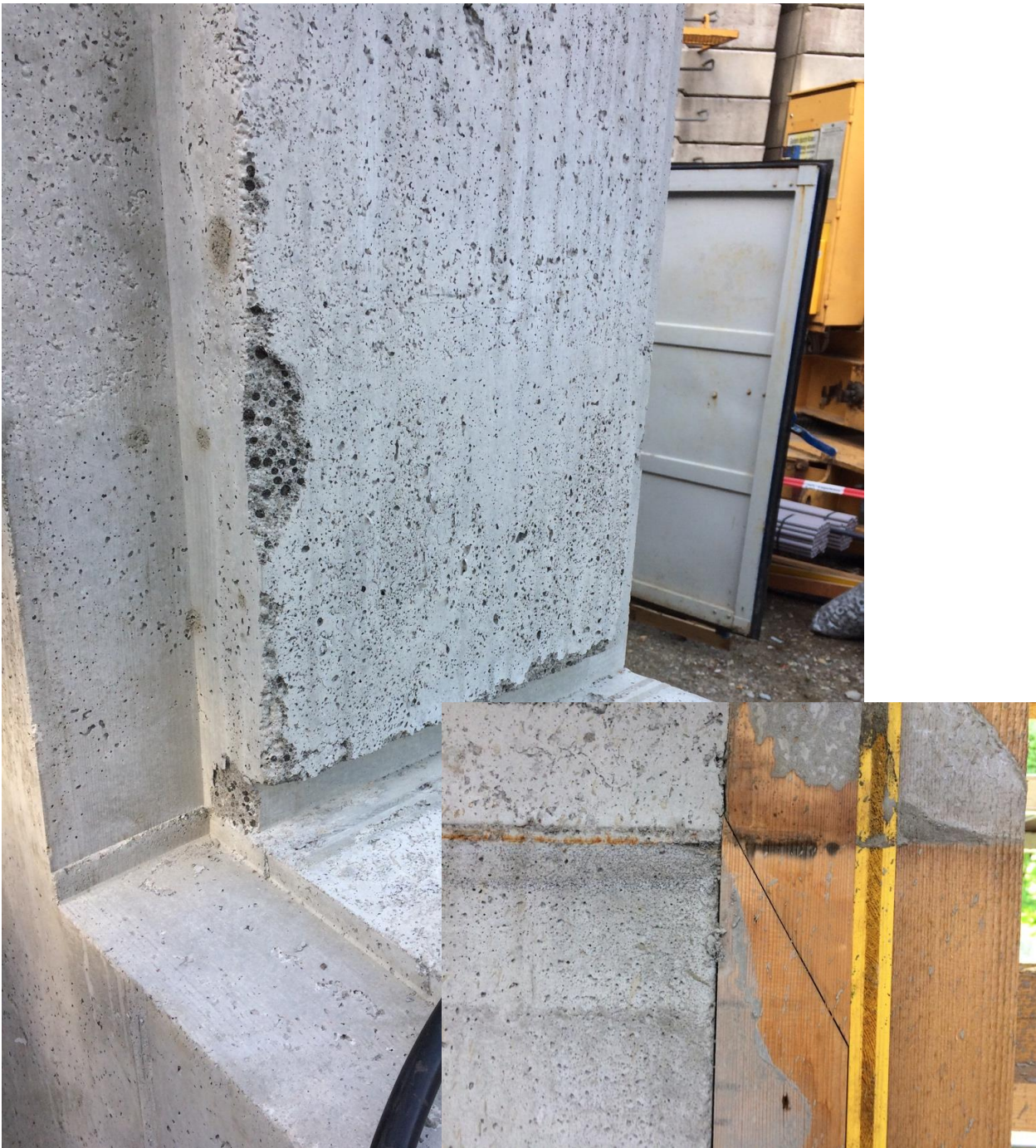
Abbildung 7: Durch die poröse Struktur des Infraleichtbetons ist es beim Ausschalen zu Abplatzungen gekommen.
