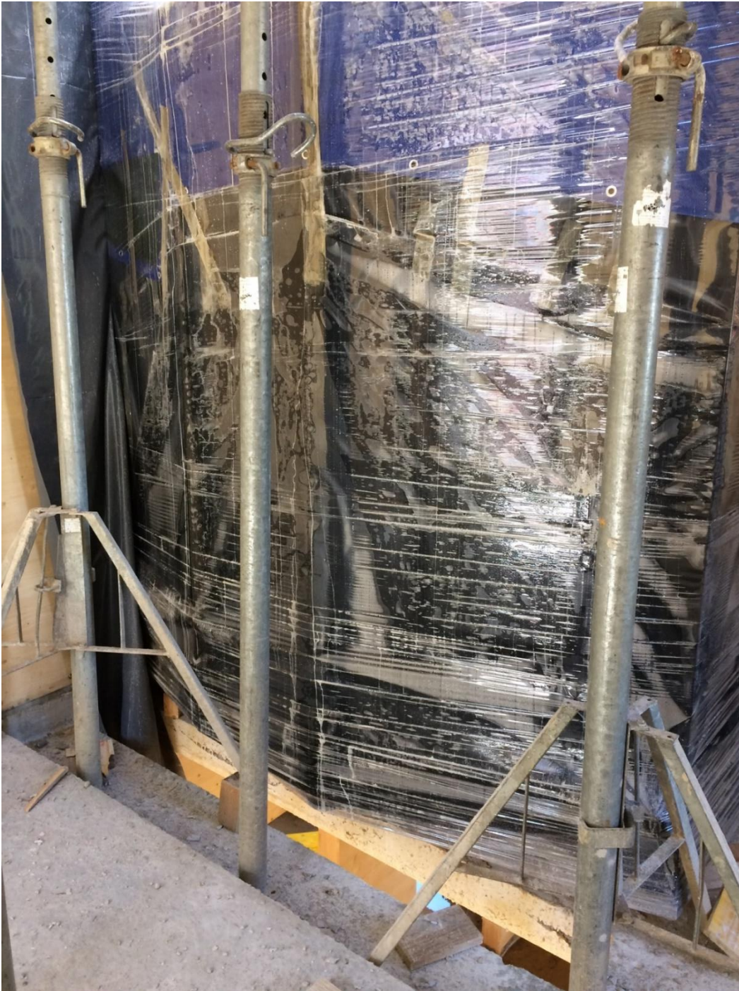
Abbildung 33: Die fertigen Badzellen sind in den entsprechenden Vertiefungen auf der Geschossdecke abgestellt und an den vertikalen Durchbrüchen positioniert.
