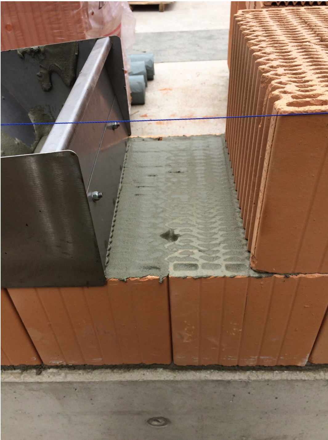
Abbildung 54: Die Luftkammern werden in jeder Steinlage mit einer Mörtelschicht verschlossen, um eine Zirkulation über die Steinlagen hinweg zu vermeiden.
