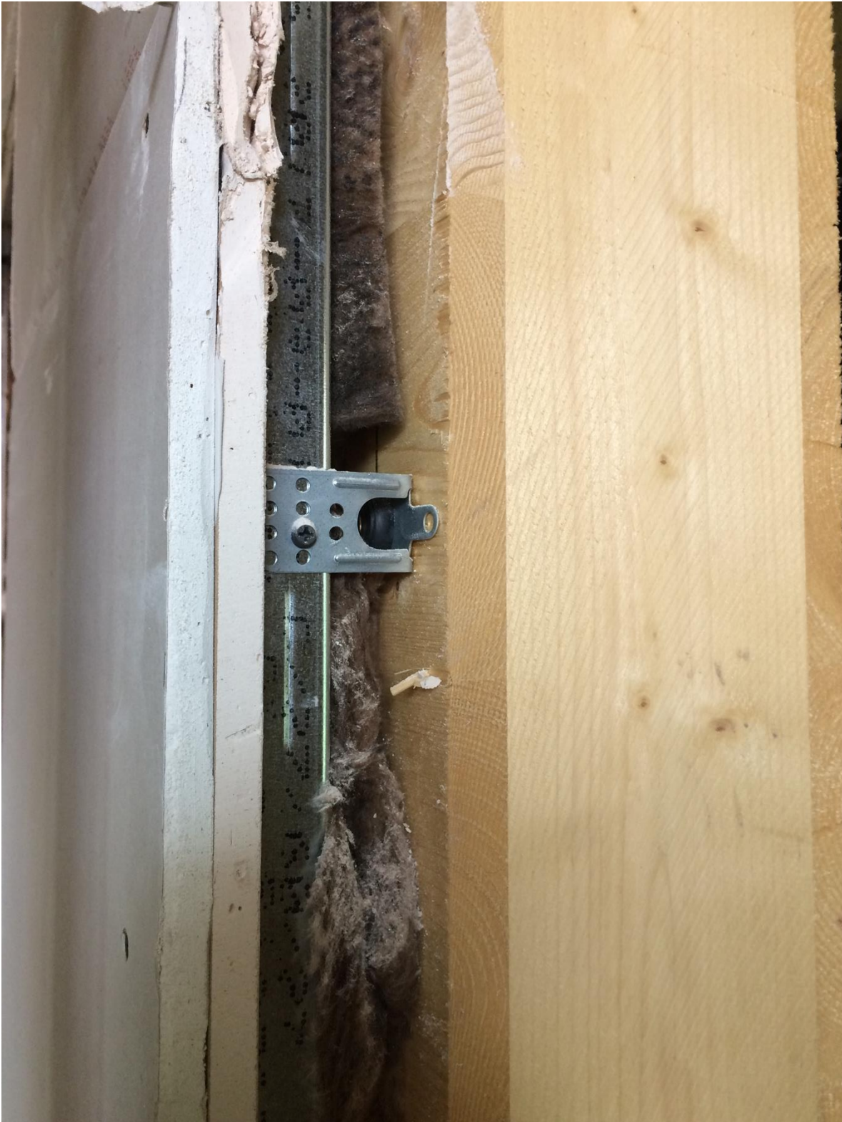
Abbildung 43: Die Wohnungstrennwände werden mit einer zusätzlichen Schicht aus Leichtbauplatten verkleidet, um die notwendigen Schallschutzwerte zu erreichen.
