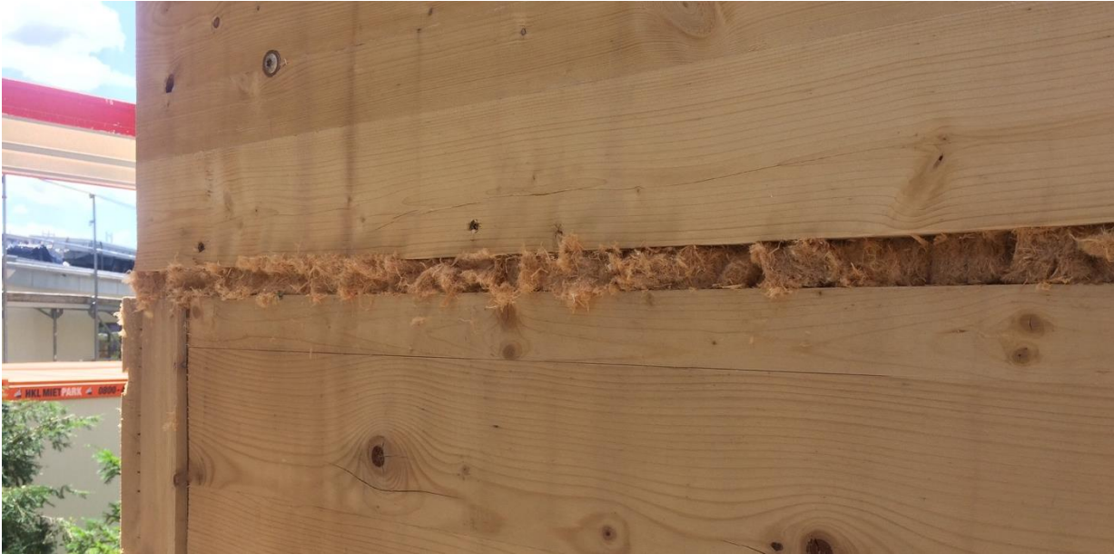
Abbildung 38: Auch von Geschoss zu Geschoss wird an den Außenwänden eine Fuge ausgebildet.
