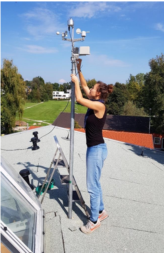
Abbildung 94 Installation der Wetterstation auf dem Dach des Leichtbetonhauses
