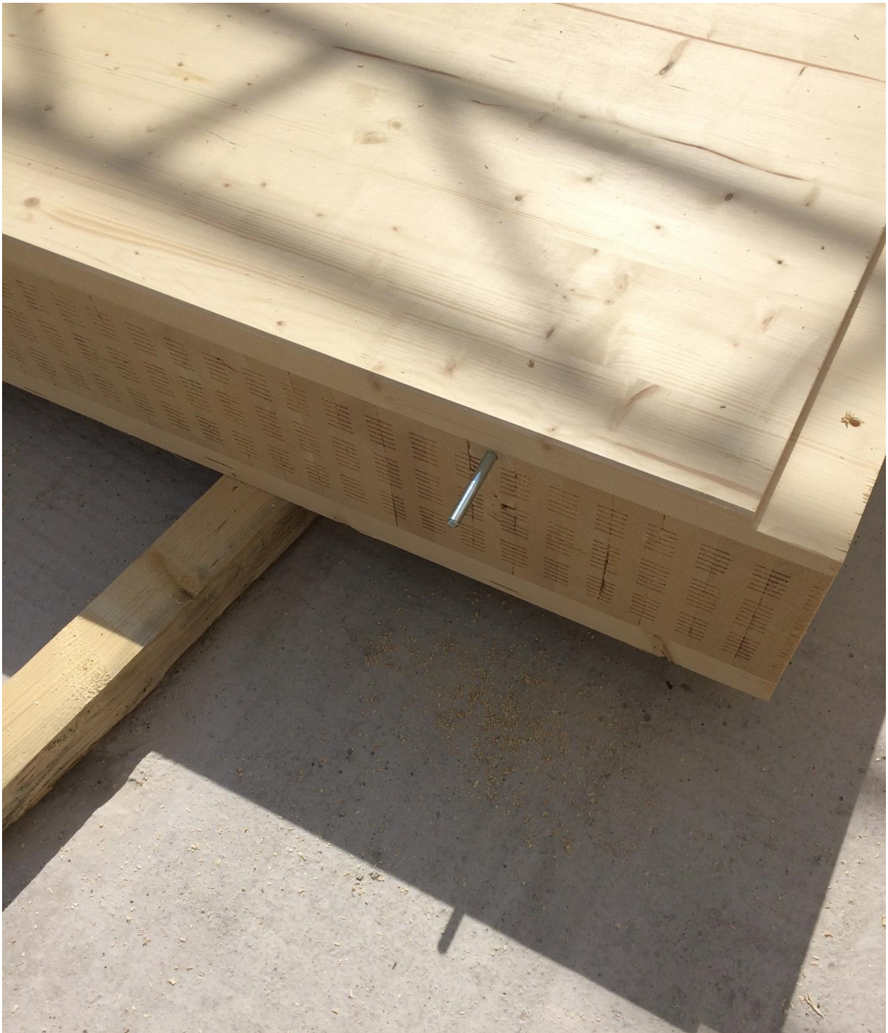
Abbildung 22: Ein 12 mm dicker Stabdübel wird oben in den Kopf der Wand gesteckt, um eine statische Verbindung zur Stahlbetondecke zu erreichen.
