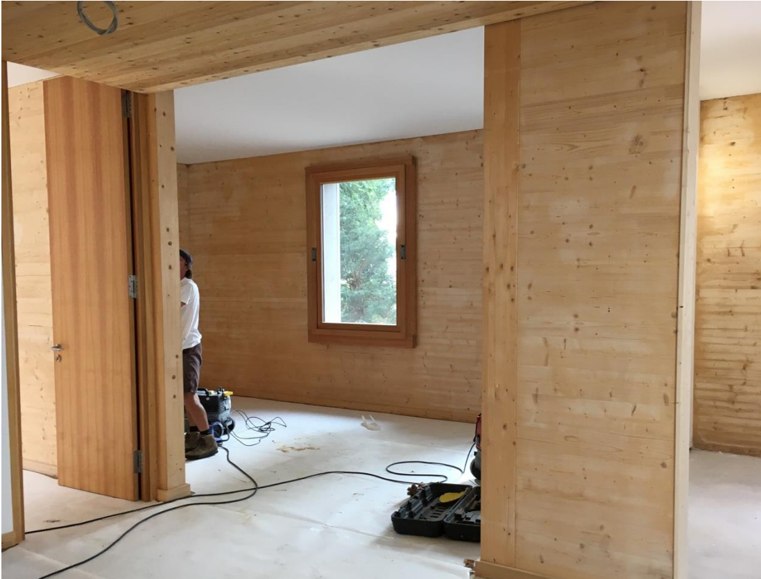
Abbildung 47: Da die Holzoberflächen durch Regen und Betoniervorgang doch hier und da gelitten haben, wurde dort Trockenbauschleifgerät nachgeschliffen.
