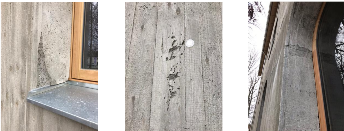
Abbildung 86: Kantenabbruch im Eckbereich (links), Abplatzungen (Mitte) und Fugenausprägung zwischen Betonchargen (rechts)
