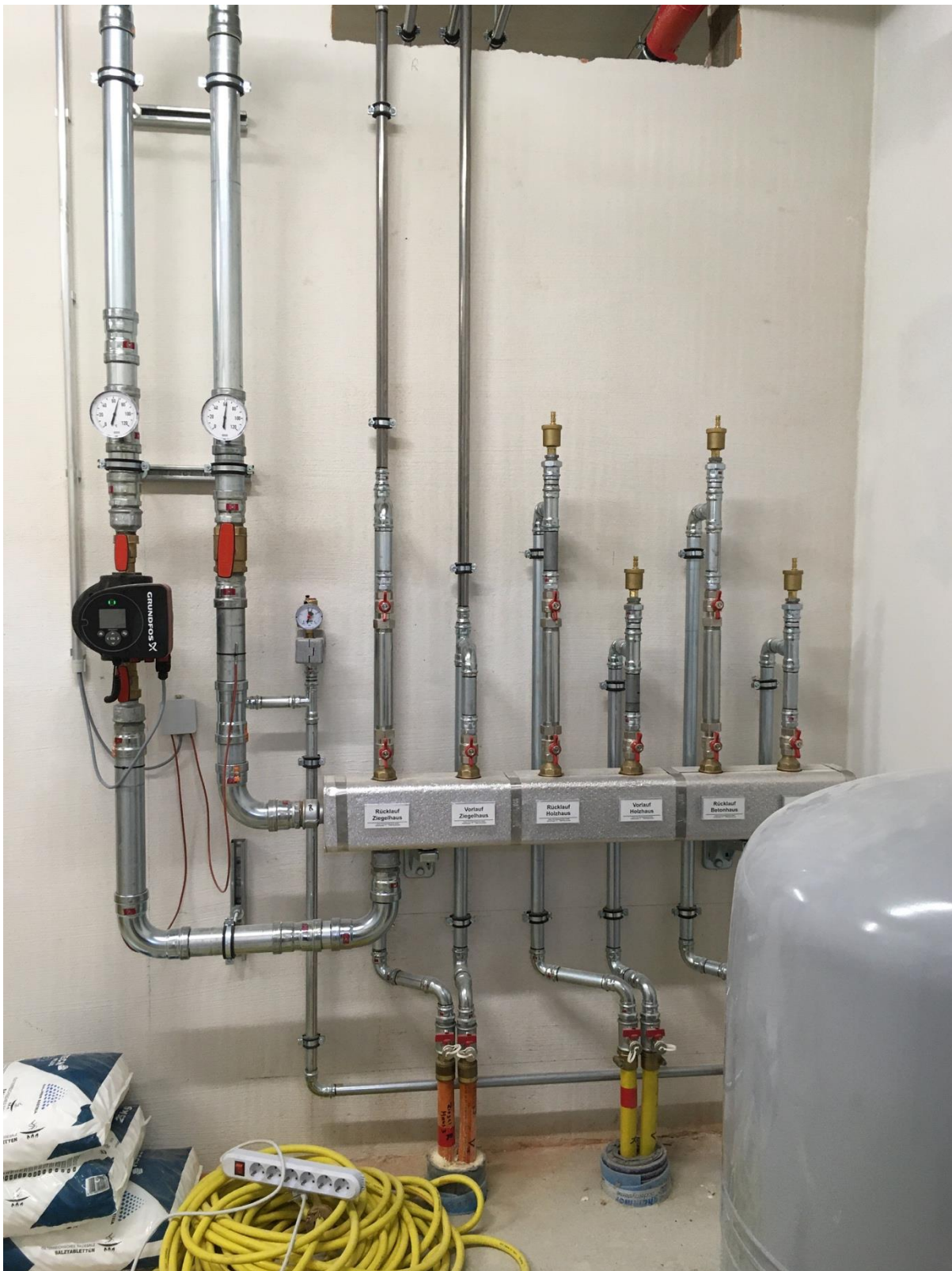
Abbildung 65: Hier erfolgt die Verteilung der Wärme für Heizen und Warmwasser in die drei Häuser.
