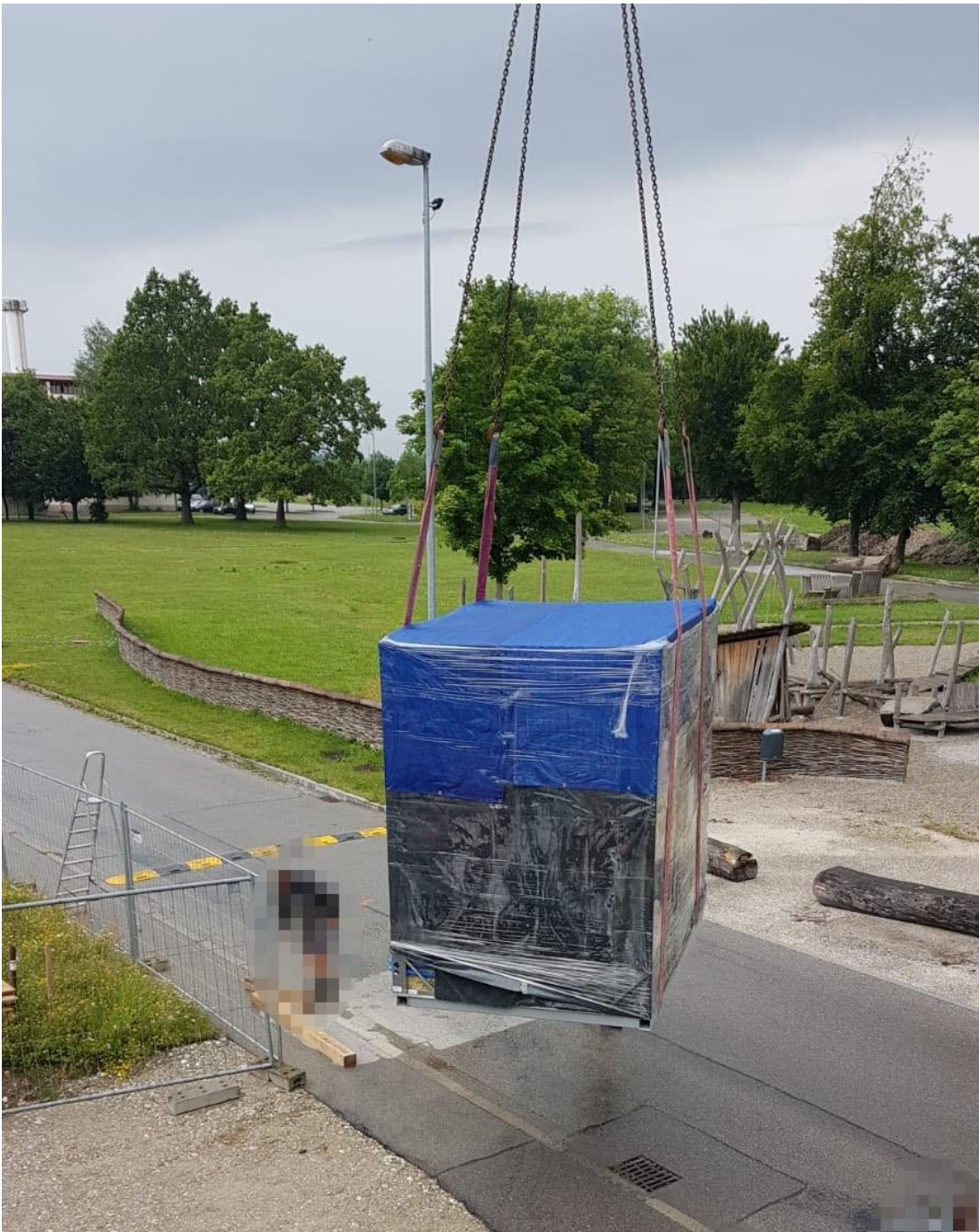
Abbildung 9: Eine vorgefertigte Badzelle wird in den Rohbau eingebracht. Sämtlich Bäder wurden in allen drei Forschungshäusern vorgefertigt.
