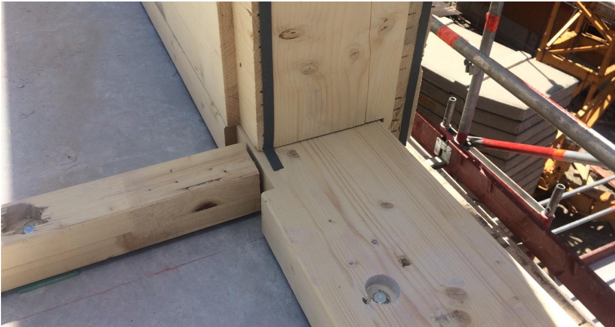
Abbildung 36: Hier ist eine Außenwand montiert. Links ist das Holzprofil für die Innenwand sichtbar.
