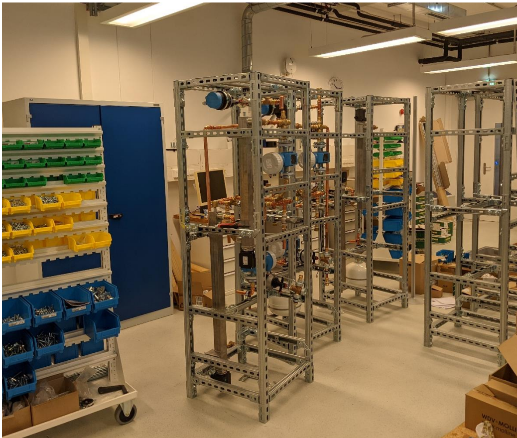
Abbildung 26: Im Aufbau befindliche Hardware-Module der Wärmeseite des CoSES-Labors in der Werkstatt der MSE; das MEMAP-Team der TUM hat am Aufbau der Hardware mitgewirkt
