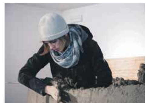
Aufbau mit Studenten des Design Build Studio der TU München © Leonie Morano
