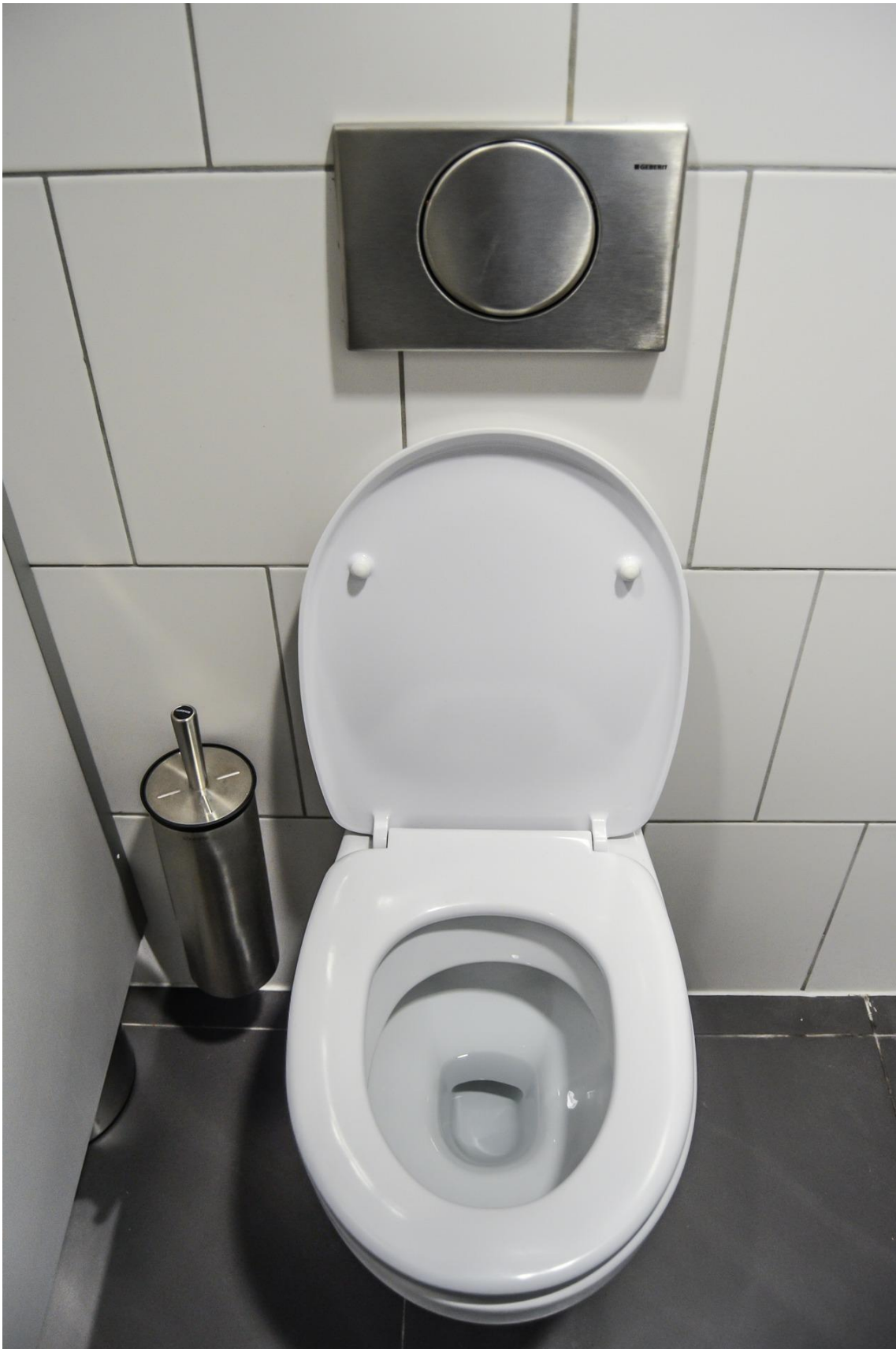
Anhang: Abbildung 15: Toilettenspülung
