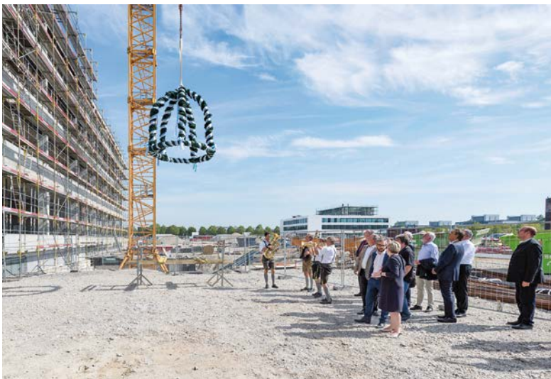
Mit Richtkronen und Musik wurde das Richtfest für den ersten Bauabschnitt des neuen Gebäudes der Fakultät Elektrotechnik und Informationstechnik gefeiert.
