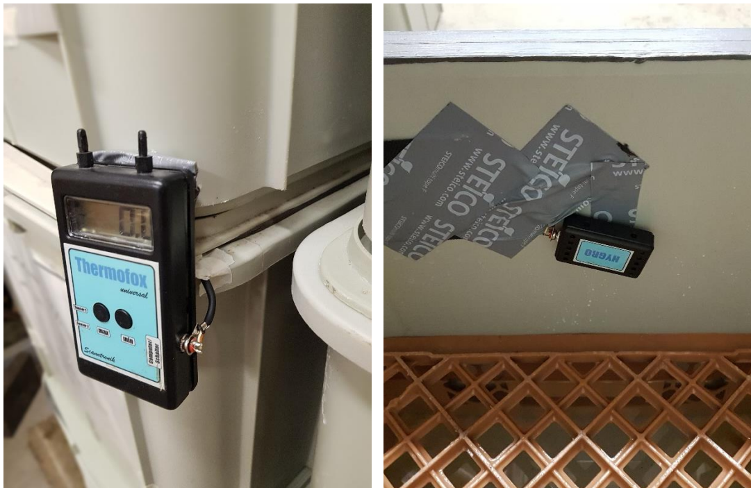
Abb. 35 - Fix installiertes Feuchte- und Temperaturmessgerät
