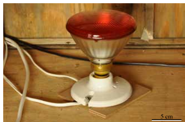
Abb. 313 Rote Lampe rechts im Technikfach
