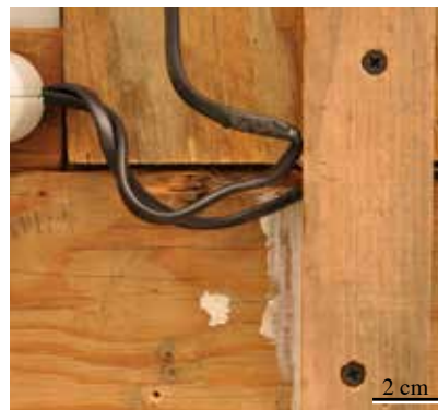
Abb. 149 Isolierungsschaden, Kabel zwischen Leuchtstofflampe I und II
