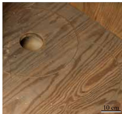
Abb. 34 Loch im Boden
