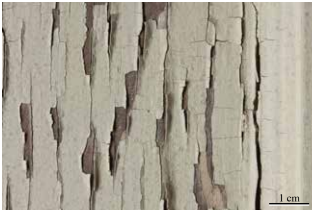
Abb. 95 Außenseite, hochstehende Schollen
