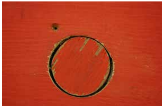
Abb. 361 Öffnung im Technikfach
