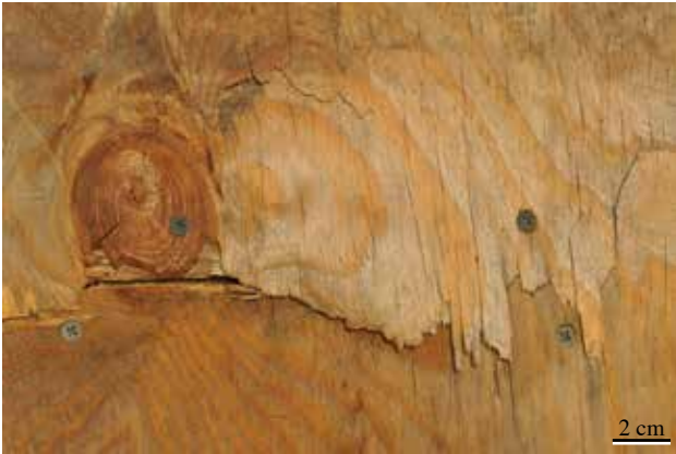
Abb. 36 Riss in der linken Seitenwand, außen
