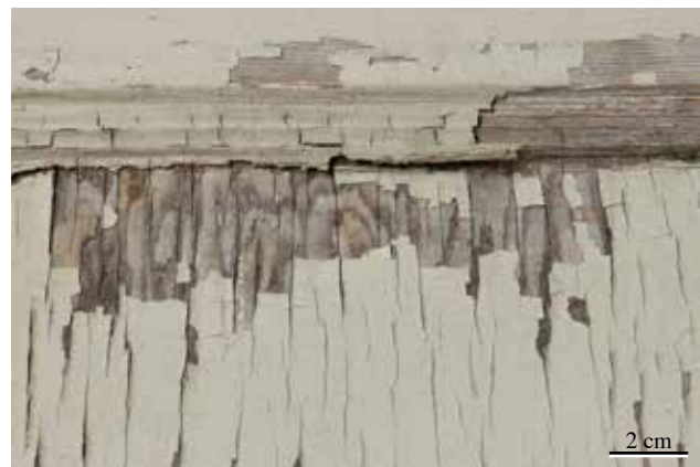
Abb. 94 Außenseite, abstehendes Schichtenpaket
