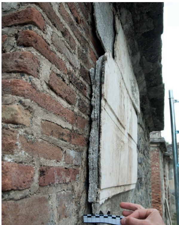
Abb. 5: Ablösung der Putzschichten vom Mauerwerk und Schichten-trennung bei Grabbau EN 6. Es ist ein vierschichtiger Putzaufbau zu erkennen, wobei auf drei Unterputzschichten eine Oberputzschicht folgt.
