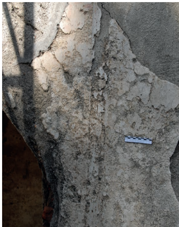
Abb. 6: Oberflächenschäden am Stuck des Grabbaus EN 4.
