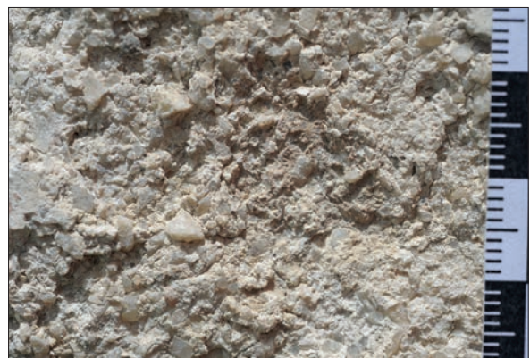
Abb. 17: Grabbau EN 6: Heller Oberputz. Der Oberputz wirkt trotz des Schadensbildes deutlich kompakter als bei EN 4.
