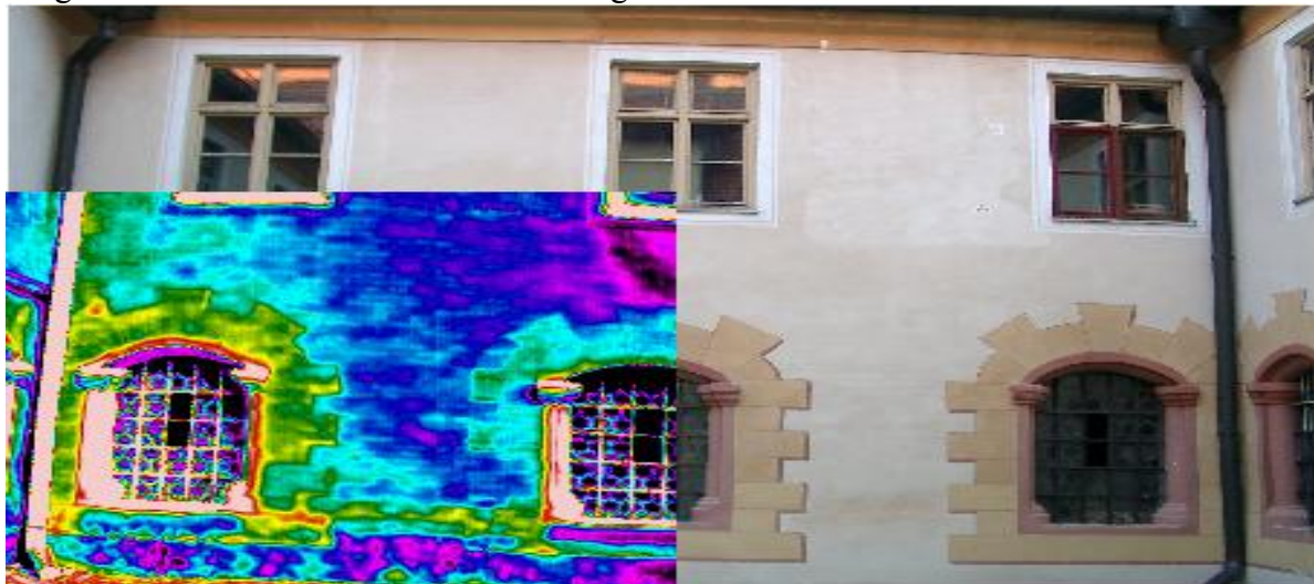
Abb. 19: Feuchtebelastung der Westfassade des Innenhofes, Klosteranlage Beyharting. (Quelle: HOTTER 2003, S. 1)
