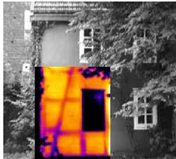
Abb. 22: Fachwerk unter Putz. (Quelle: http://bautrocknung.de/_Bautrocknung/_messtechnik/_agema_470.htm )
