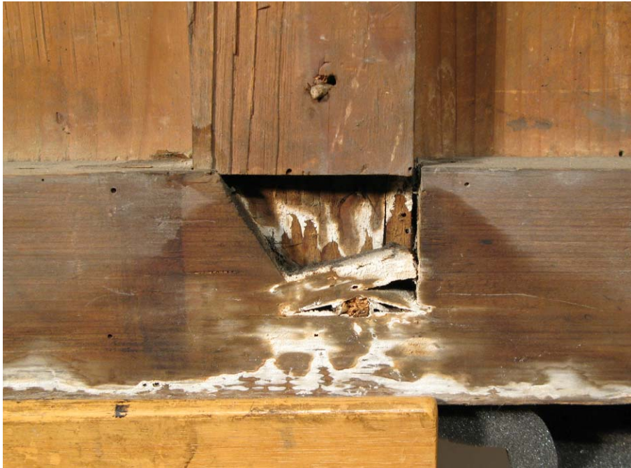
Abb. 50 Rückseite; unterer horizontaler Rahmenfries mit ausgestemmt (?) Holzstück, Holznagel, Wasserflecken und weißen Ausblühungen
