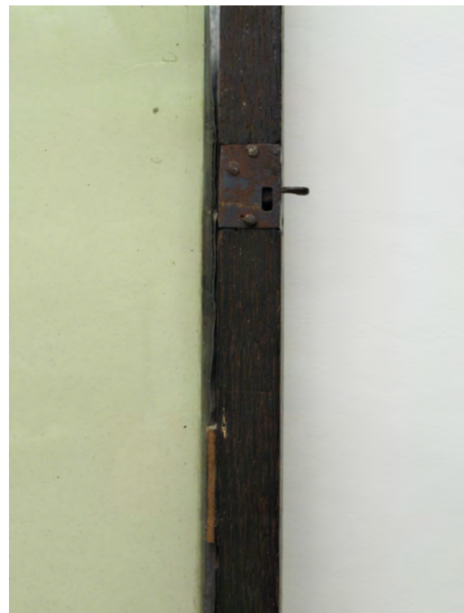
Abb. 80: rechte Türe, Hebelschloss und Holzklötzchen
