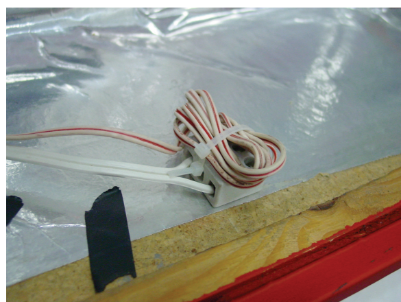
Abb. 62 PONG , Loses Kabel nach Befestigung
