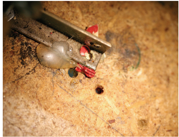
Abb. 10 PING , unbenutzte Befestigungsbohrung
