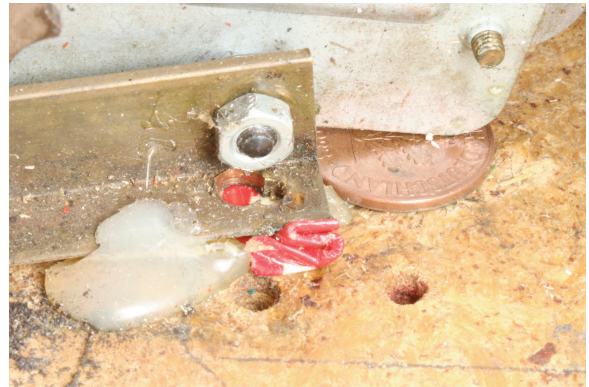
Abb. 35 PING , Verunreinigungen auf der Bodenplatte
