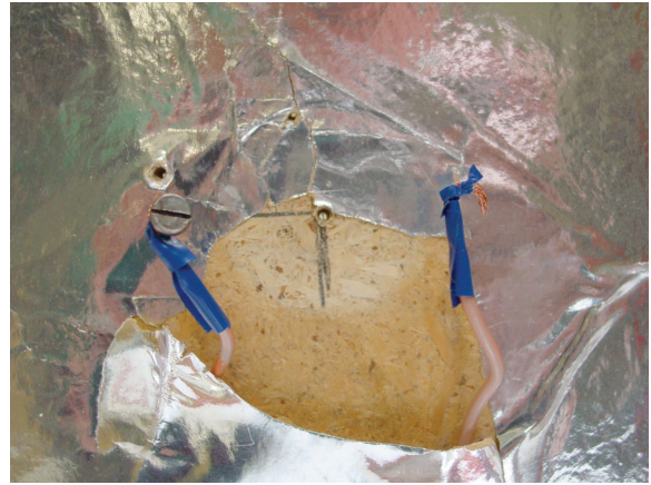
Abb. 59 Eingerissene und abgelöste Aluminiumfolie unter einer Glühlampenfassung Nach der Festigung
