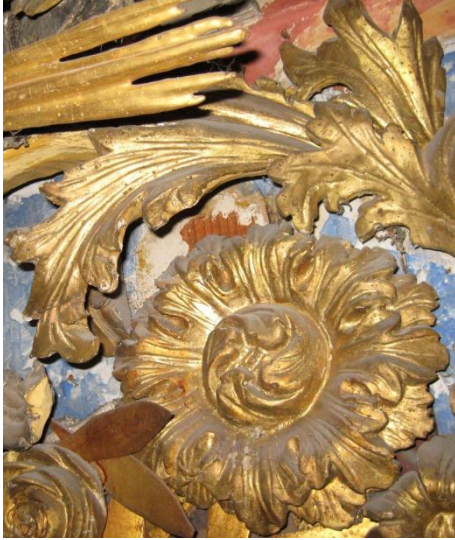
Abb. 30: Holzlichtiger Bereich hinter Ornament unterhalb vom Gesims.
