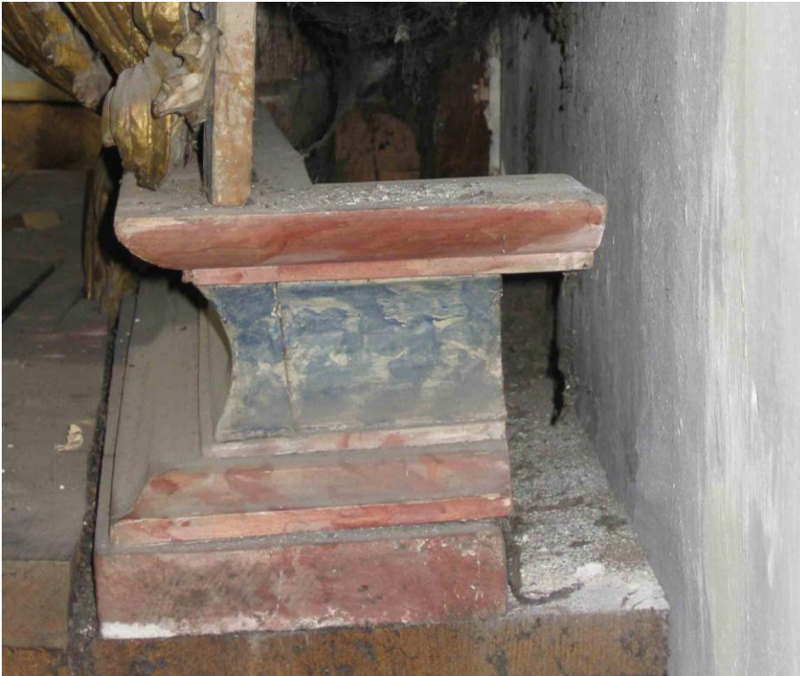
Abb. 93: Retabel, Unterkonstruktion steht ohne konstruktive Verbindung auf der Predella.
