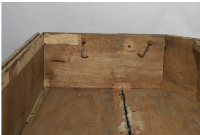
Abb. 114: Innenseite von Kranzgesims mit Eisenhaken
