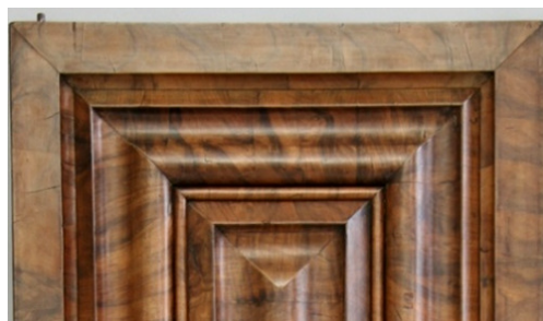
Abb. 23: Linke Tür, rechtes Profil ist breiter, Abdruckspuren der Schlagleiste sichtbar.
