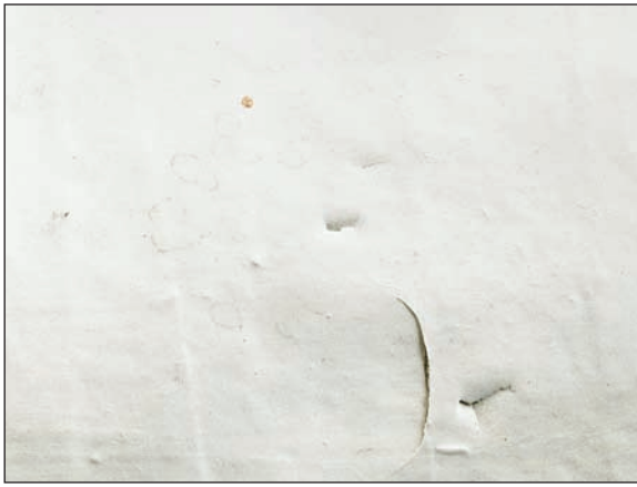
91: Tragfläche, Fleckenbildung durch Feuchtigkeit.
