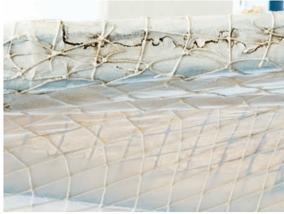
70 Spannungsriss durch auseinandergedriftete Streben
