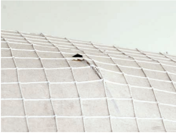
69 Bruch, entstanden durch Deformation einer Rippe
