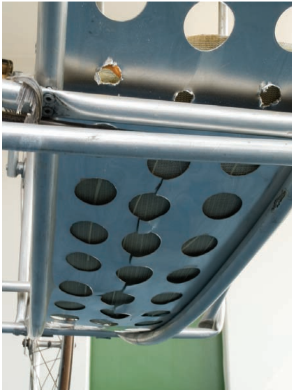
56 Bruch im Lochblech der Sitzschale
