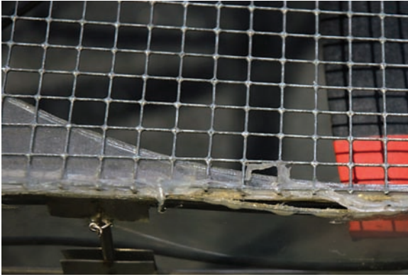
83 Defekte Klebung in der Makrolonhaut mit Reparatur-Klebstoffresten
