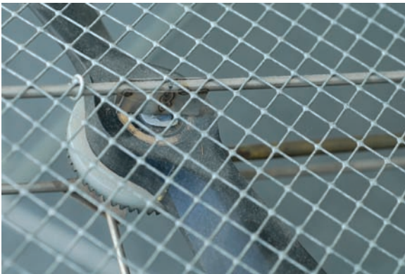
86 Defekte Unterlegscheibe ließ Abrasion durch Schweißplättchen am Rotor zu
