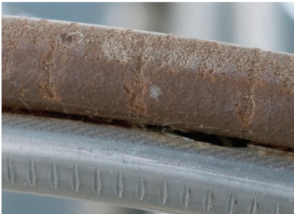
61 Belastungs-Risse quer zur Laufrichtung, Lauffläche abgeschliffen
