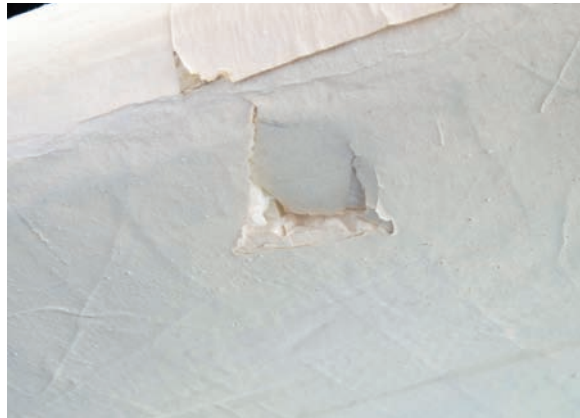
65 Eingedrückter, eingebrochener Bereich an Tragfläche
