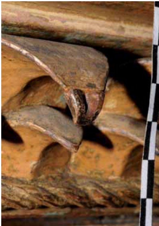
Abb. 164: Gebälk-Kranzgesims, Blattband in Kehle; fehl platziertes und verleimtes Bruchstück.
