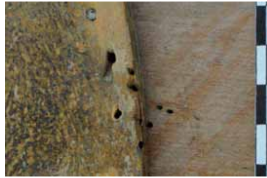
Abb. 161: Lünette, rechte Regenbogenhälfte am Übergang zur Rücklage; Nagellöcher von mehreren Montagen/Demontagen.
