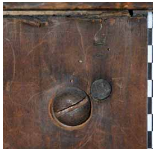
Abb. 98: Hauptgeschoss/Säulenrücklage, RS, rechts oben, am Übergang zum Gebälk-Bodenplatte; Holzschraube (hier keine Markierung) und Eisenstift; über dem Stift finden sich zwei Kerben, die exakt die Senkrechte zwischen Stift und sichtbarem Gewinde markieren.
