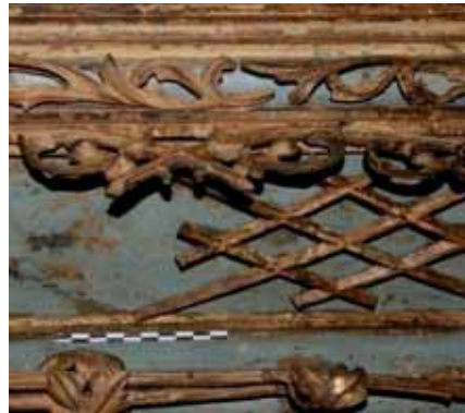
Abb. 40: Unteransicht des Gebälks, Gitterwerk (links: Verlust eines Feldes).
