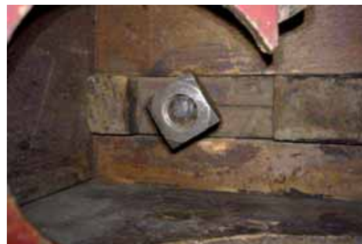
Abb. 100: Schlitz-Zapfen-Verbindung zum Predellen-Kasten mit eiserner Gewindestange und ergänzter Mutter (verm. gegossen) der rechten Seite; die fehlende Unterlegscheibe zeichnet sich als Verfärbung am Holz ab.
