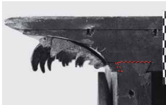
Abb. 78: Gebälk-Deckplatte, RS, links; Gratverbindung von der Seitenwand mit dem unteren Brett der Deckplatte ist mittels zweier Keile (rot gestrichelt) stabilisiert. Aufgrund Krafteinwirkung, kurzer Distanz zur Profilkante und Faserverlauf des Deckplattenbrettes ist die Nut links ausgebrochen.
