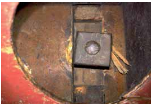
Abb. 99: Schlitz-Zapfen-Verbindung zum Predellen-Kasten mit eiserner Gewindestange und handgeschmiedeter Mutter der linken Seite.
