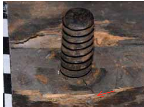
Abb. 93: Gebälk-Kasten, RS, linke Gewindestange ohne Mutter mit sichtbaren Abdrücken der Unterlegscheiben; der Übergang von Gewinde zum Holz scheint nahtlos (Spannungsriss, s. Pfeil), das Holz um den Schlitz ist von der Mutter beschädigt.
