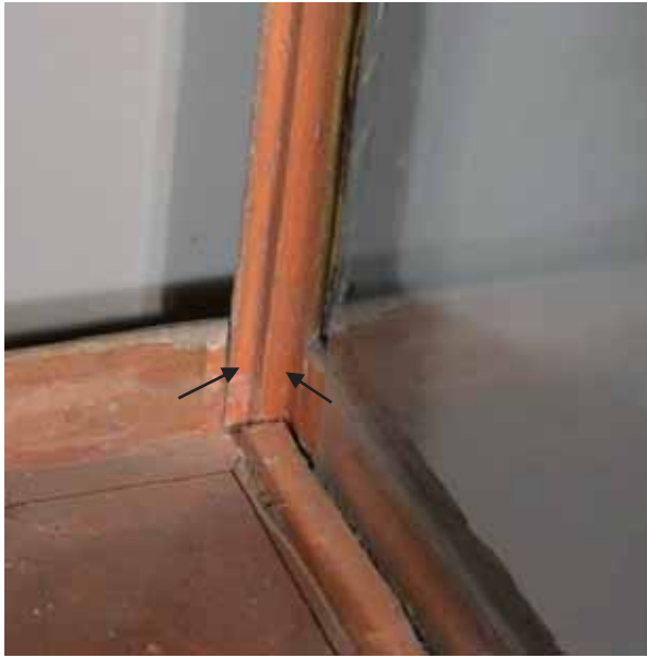
Abb. 457: Glasfalz eines vorderseitigen Lorbeerstabes
