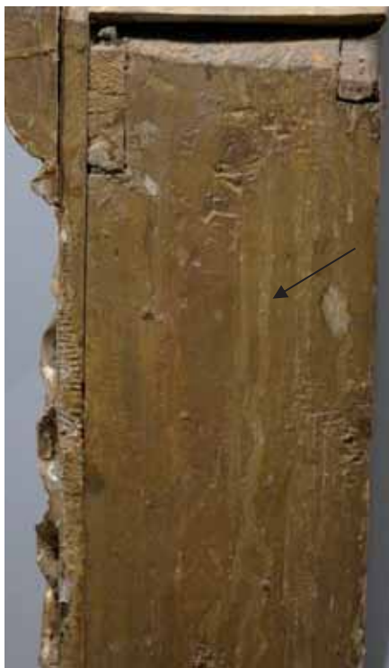
Abb. 338 (li.): Seitenwand und Dach mit Wasserflecken
