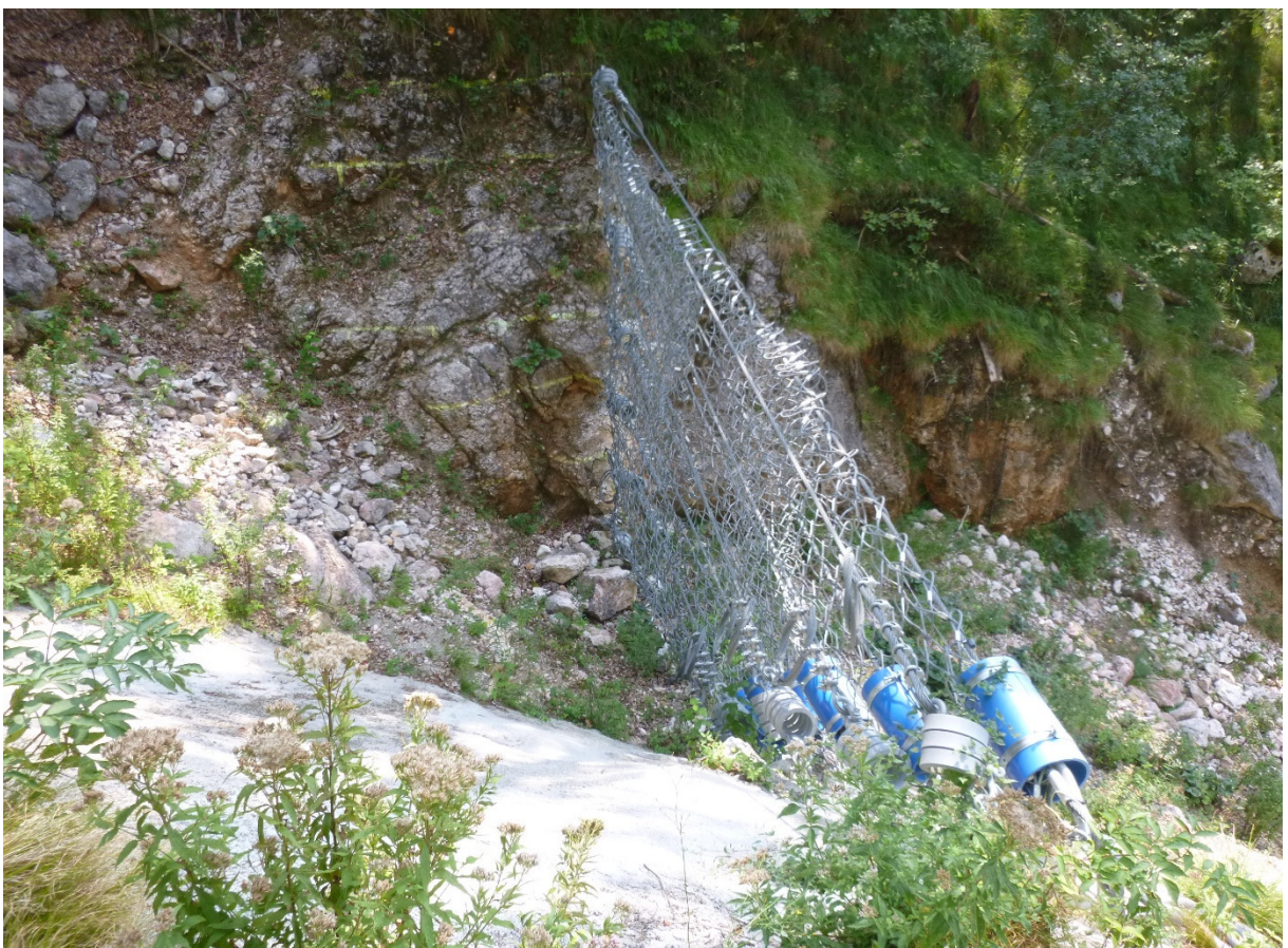
Abb. 161: Netzsperrre mit Überwachungsanlage Murgang (StBA TS - Bildarchiv).
