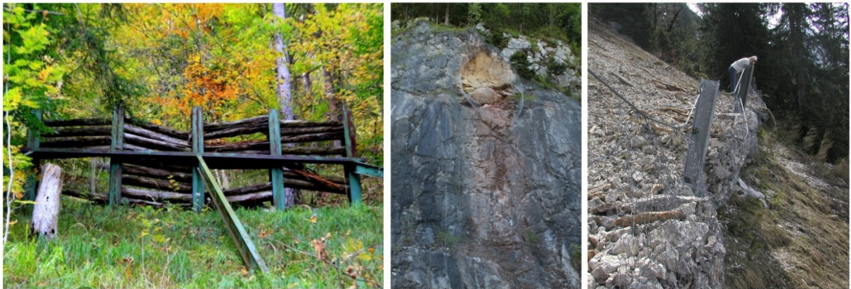
Abb. 63 - 65: Alte sanierungsbedürftige Bauwerke, die nach konstruktiven Gesichtspunkten errichtet wurden.
