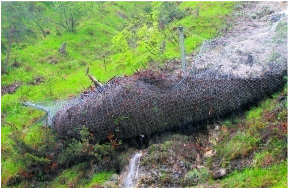
Abb. 67: Hanganbruch an der B 21 der durch einen Steinschlagschutzzäun zurückgehalten wurde (StBA TS - Bildarchiv).
