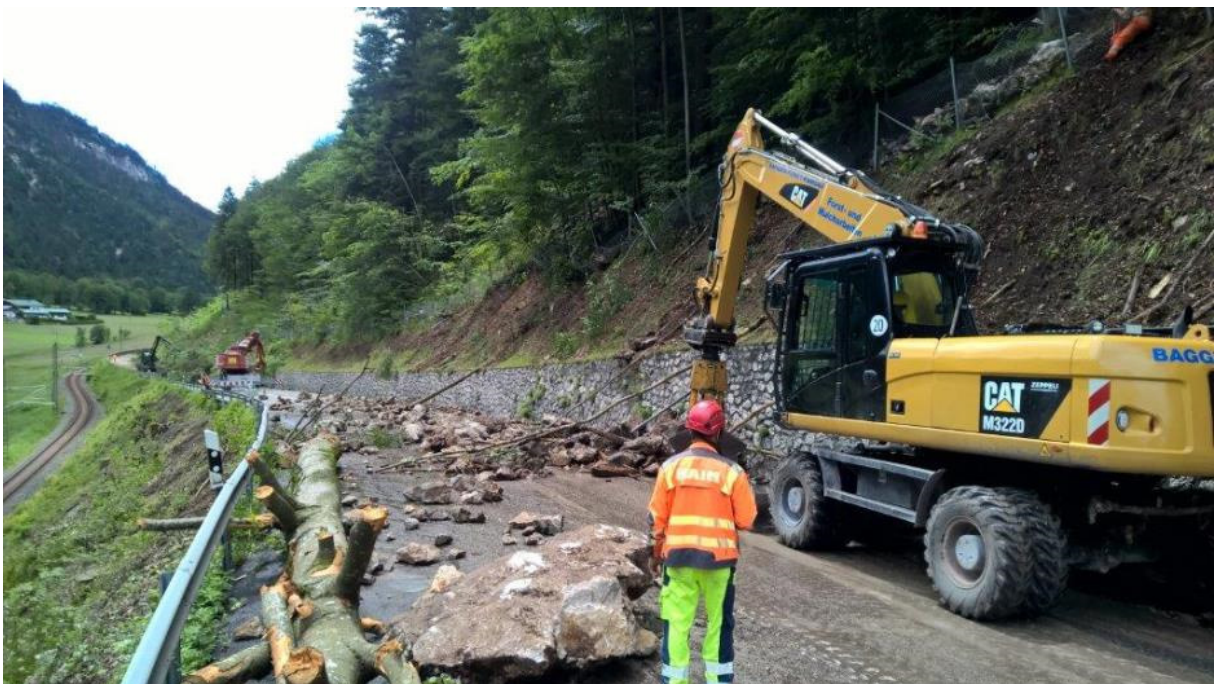
Abb. 73: Felsbräumung an der B20 im Bereich Eisenrichter Berg (StBA TS - Bildarchiv)
