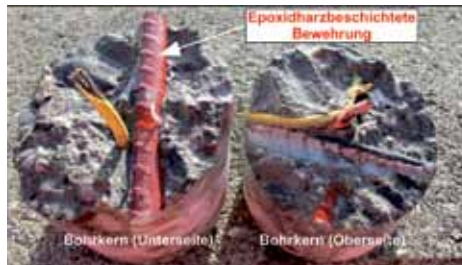
Bild 11 Freigelegte epoxidharzbeschichtete Bewehrung an einem vor Ort entnommenen und gebrochenen Bohrkern mit D = 100 mm
