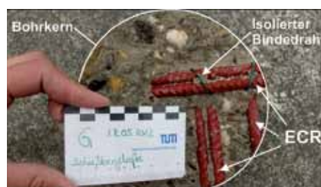
Bild 8 Freigelegte epoxidharzbeschichtete Bewehrung an der Bruchfläche (Unterseite) eines entnommenen Bohrkerns mit D=150 mm
