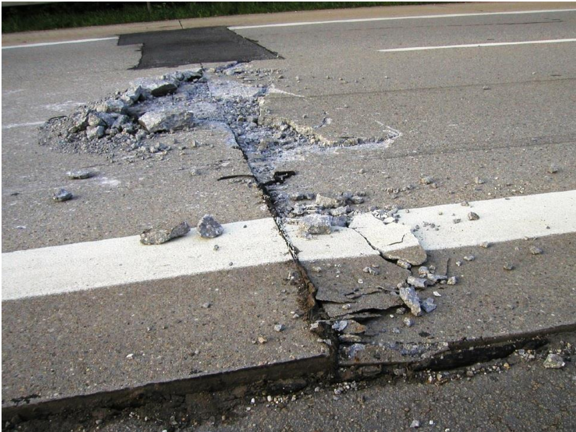
Bild 4.3: Betonausbrüche an der Querscheinfuge neben einem Teilersatz der Betonfahrbahn- decke im Nachbarfahrstreifen mit Asphalt [21]
