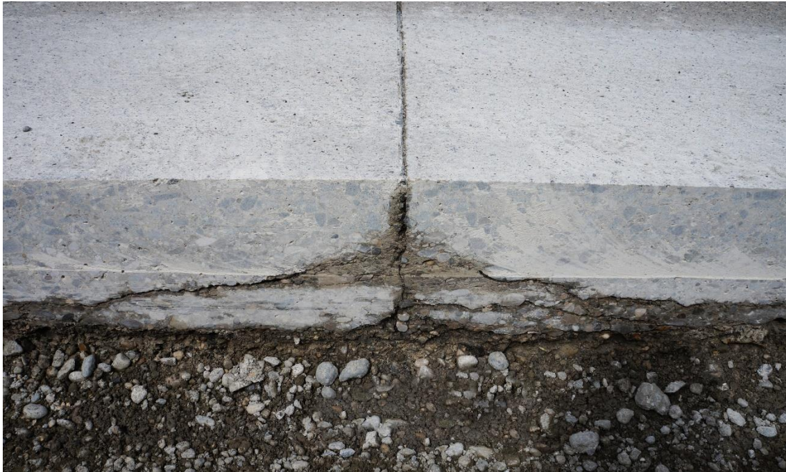
Bild 4.7: Ausbrüche im Bereich der Querscheinfuge [28]
