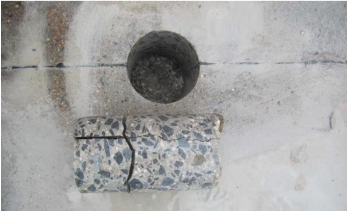
Bild 4.5: Horizontalriss im Bereich der Querscheinfuge
