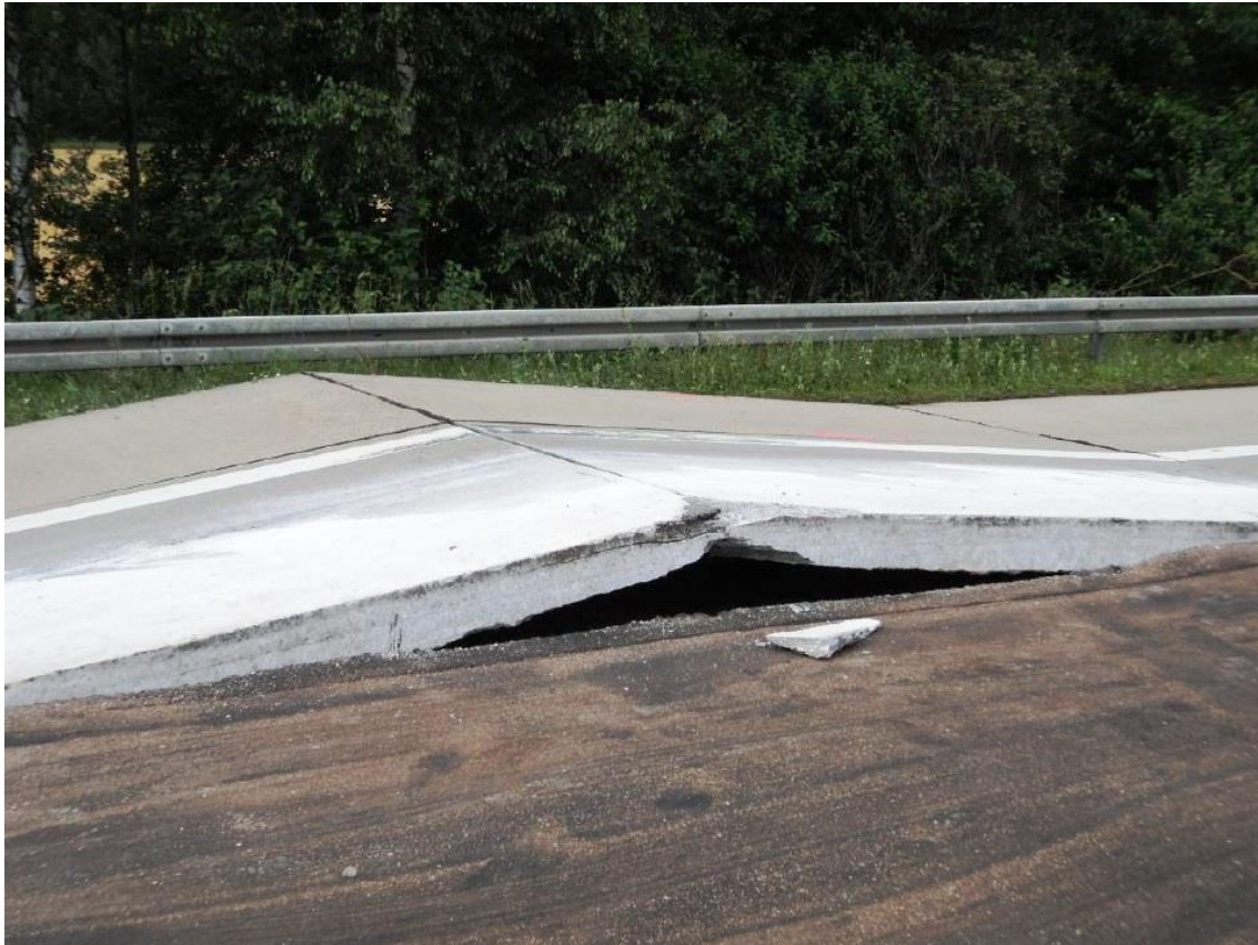
Bild 4.4: Ausknicken der Betonfahrbahnplatten neben einem Plattenersatz mit Asphalt [21]
