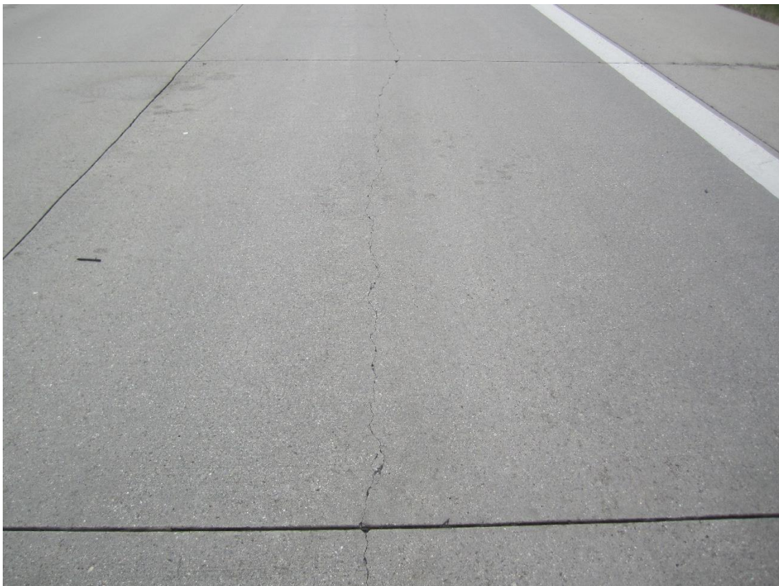
Bild 8.12: Längsrisse in der Fahrbahnplatte kurz vor einem Entspannungsbereich
