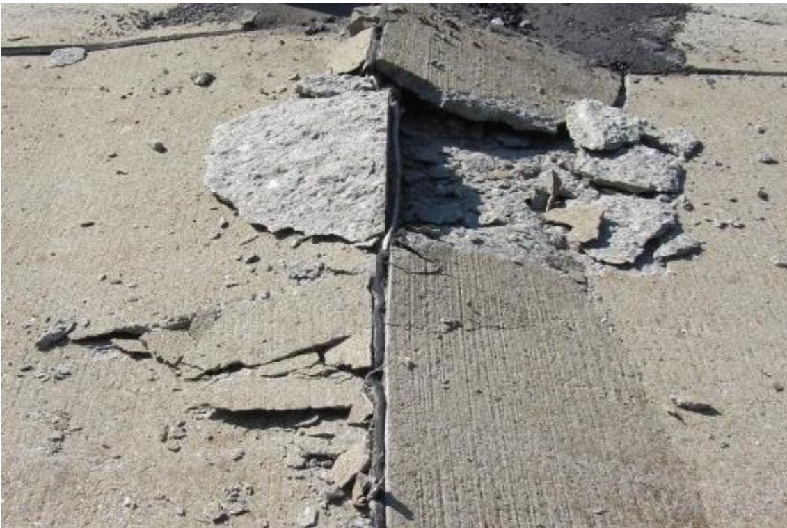
Bild 4.2: schollenartige Betonausbrüche aufgrund von Querkzugspannungen an der Fuge [21]
