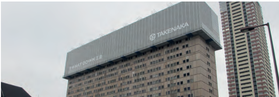
Automatisierter Rückbau von Gebäuden durch die auch in Deutschland agierende Firma Takenaka.
